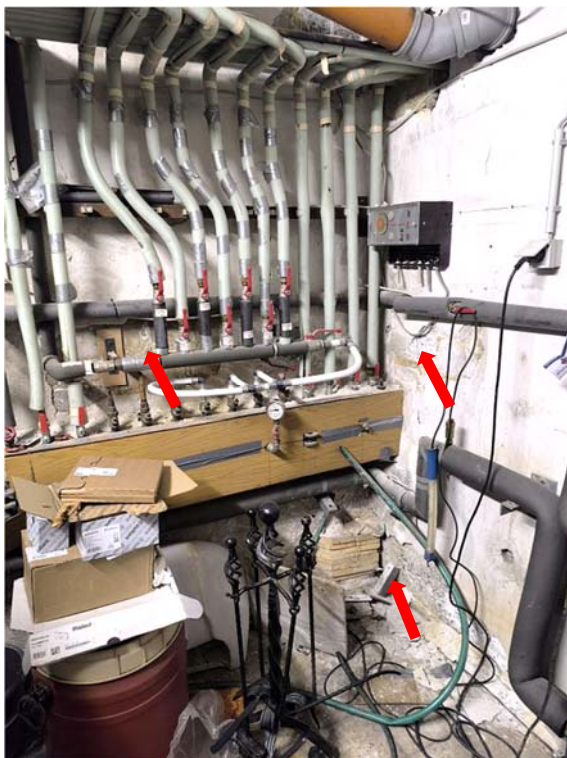
Leitungen, Feuchteschäden an Wand
