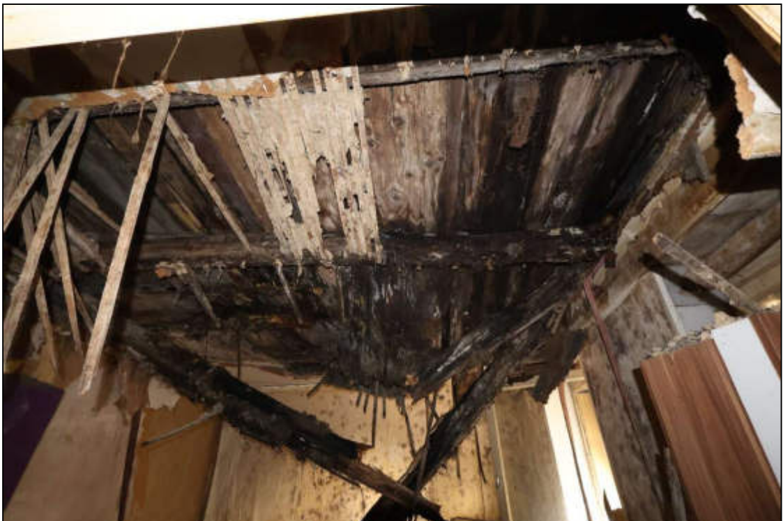
Abbildung 34 teilweise eingestürzte Deckenkonstruktion im Obergeschoss Foto Nr. 29, fotografiert am 19.03.2026
