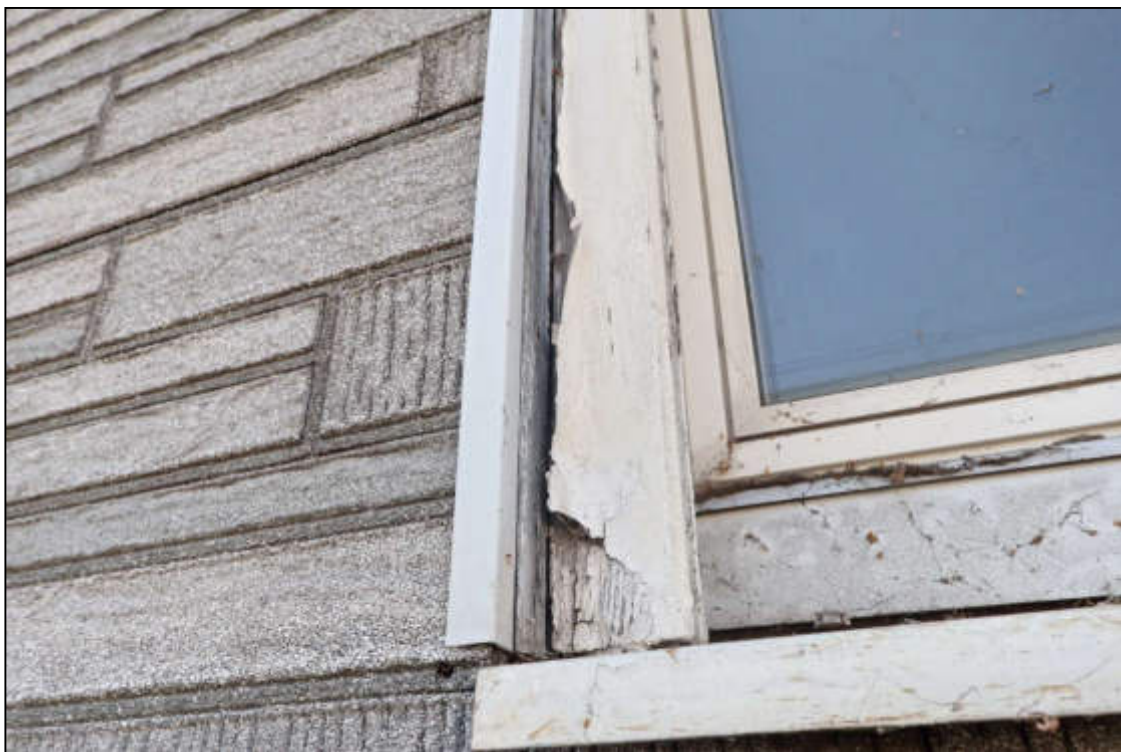
Abbildung 28 verwitterte Holzfensterrahmen Foto Nr. 23, fotografiert am 19.03.2026
