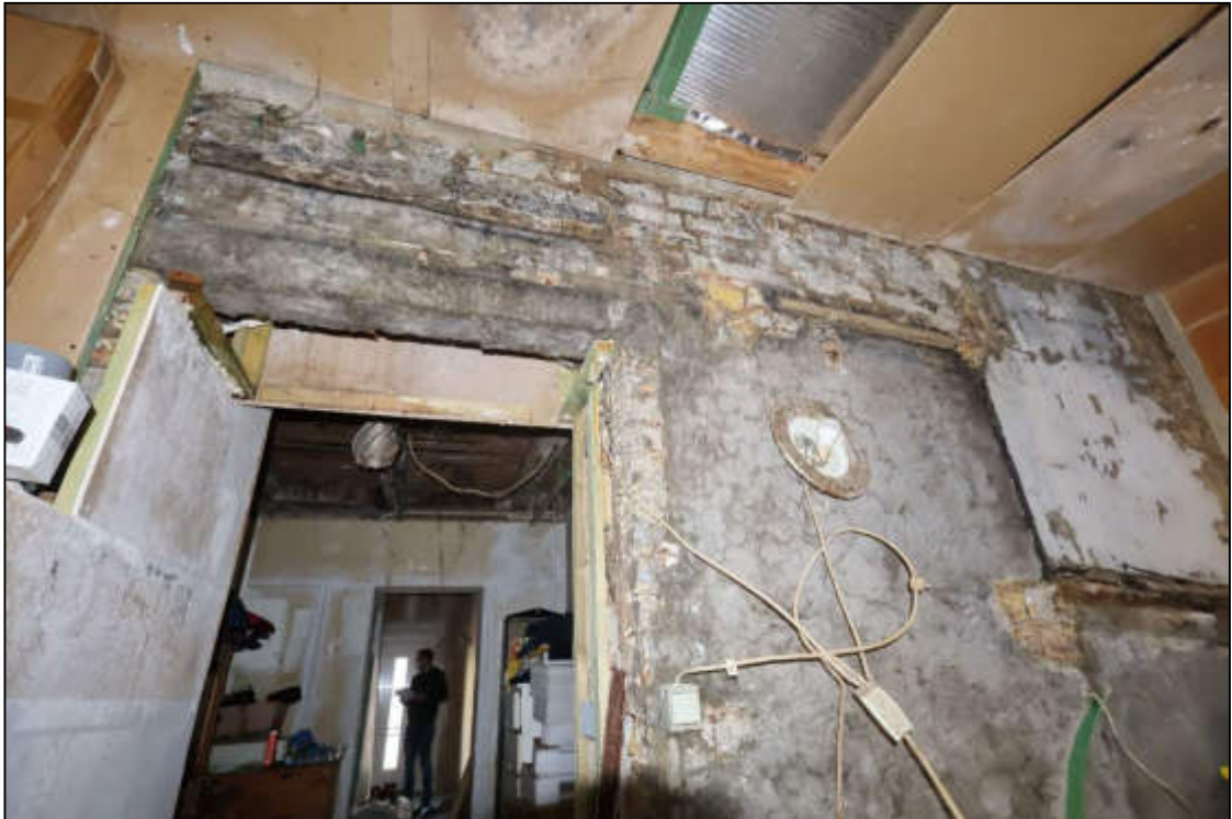
Abbildung 31 durchnässtes Mauerwerk Foto Nr. 26, fotografiert am 19.03.2026
