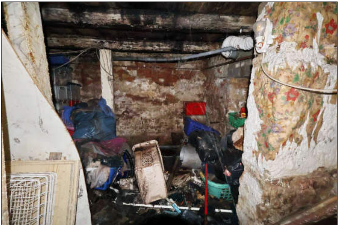
Abbildung 32 stehendes Wasser im Kellergeschoss, durchnässte Deckenkonstruktion Foto Nr. 27, fotografiert am 19.03.2026
