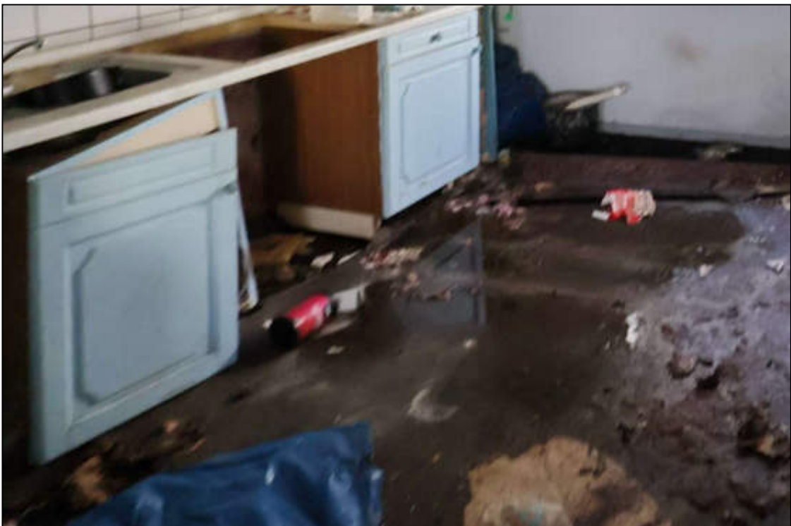
Abbildung 30 stehendes Wasser im Erdgeschoss Foto Nr. 25, fotografiert am 19.03.2026
