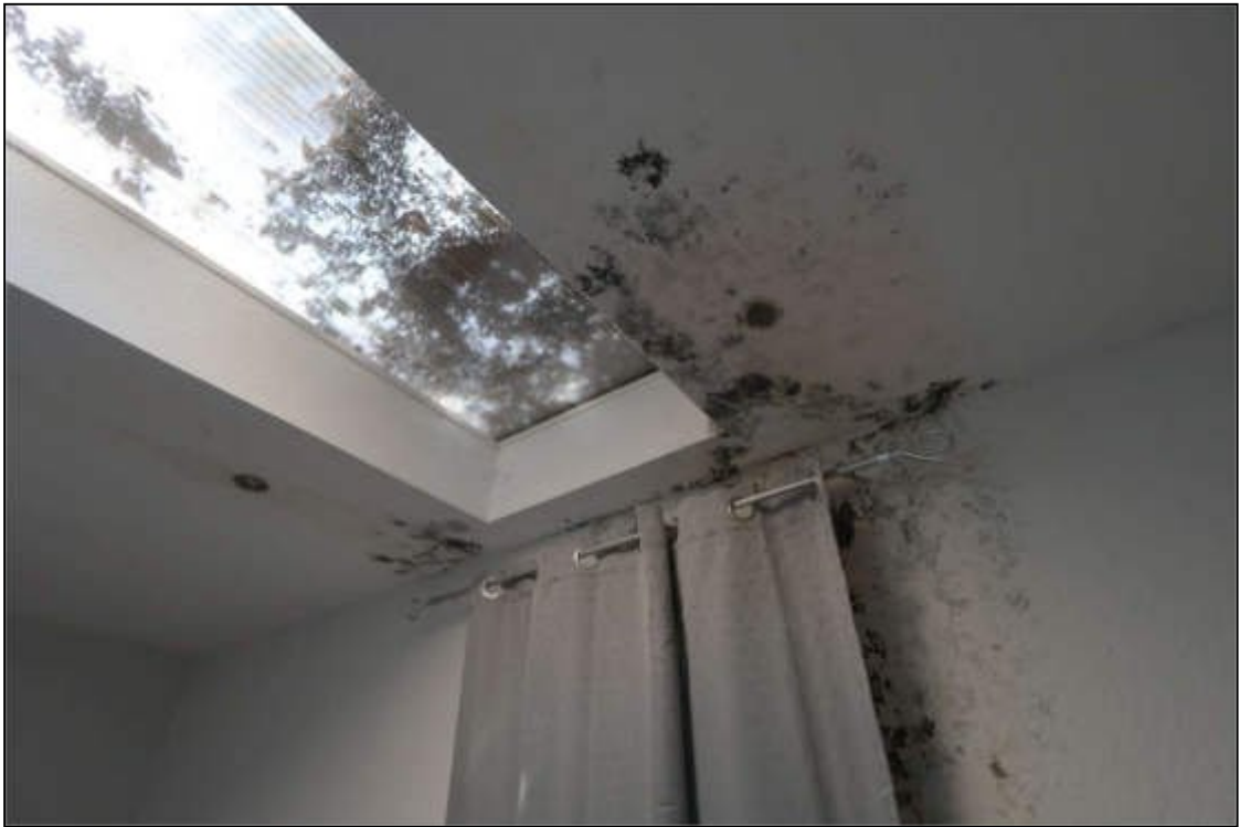
Abbildung 35 starke Schimmelbildung und Nässe im ehem. Werkstattanbau Foto Nr. 30, fotografiert am 19.03.2026
