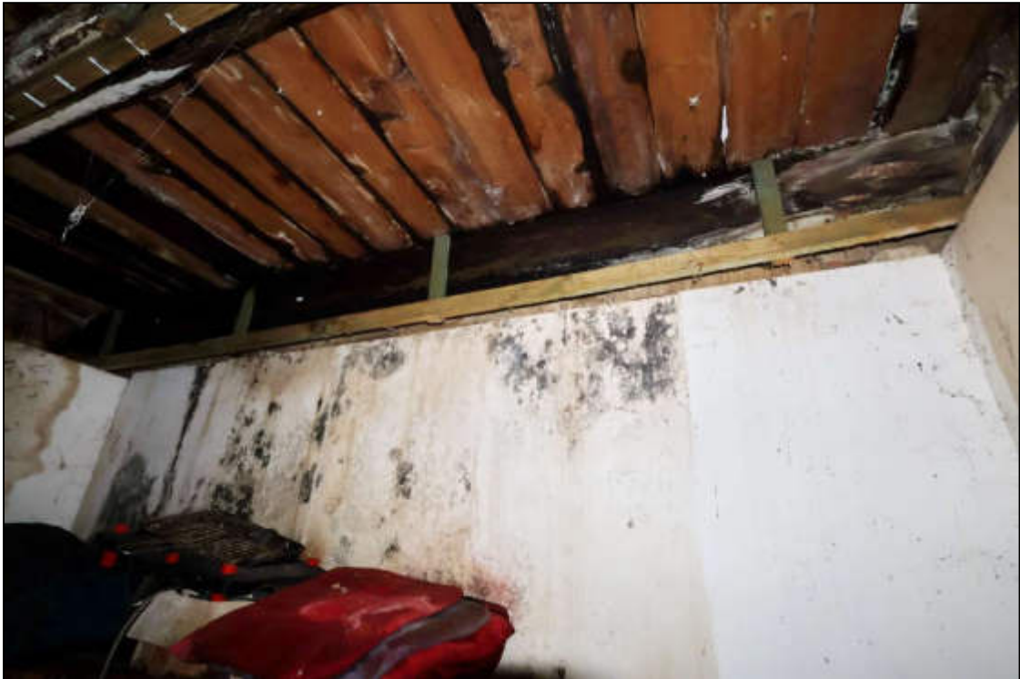
Abbildung 29 Schimmelbefall an den Innenwänden, durchnässte Deckenkonstruktion Foto Nr. 24, fotografiert am 19.03.2026
