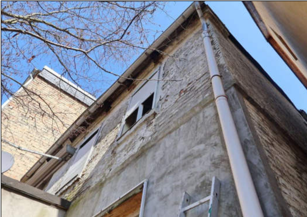
Abbildung 27 großflächige Putzabplatzungen an den Außenwänden Foto Nr. 22, fotografiert am 19.03.2026
