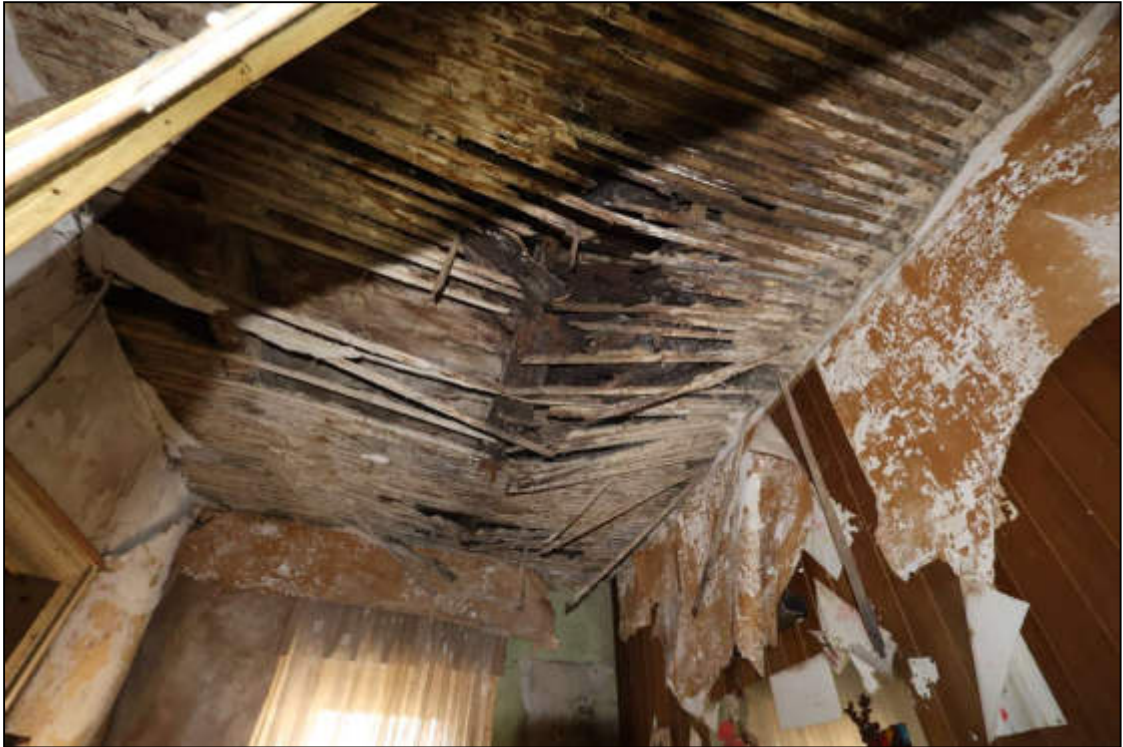
Abbildung 33 Einsturzgefährdete Deckenkonstruktion im Obergeschoss Foto Nr. 28, fotografiert am 19.03.2026
