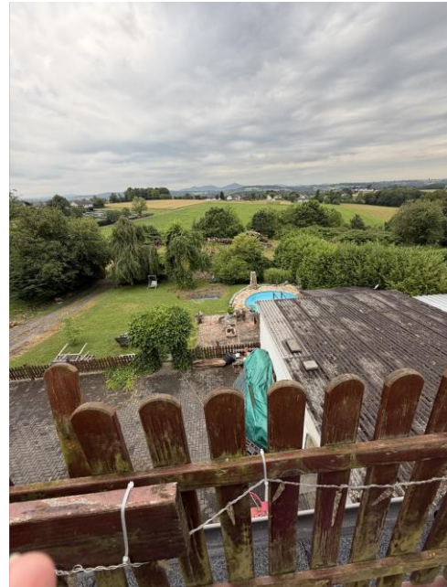
Schadhaftes Geländer Dachterrasse über Wintergarten
