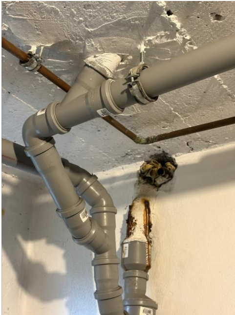
Leitungsinstitutionen unterhalb der Kellerdecke im Bereich der Waschküche
