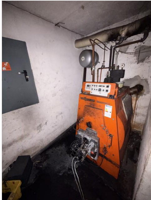
Heizungsanlage im Kellergeschoss
