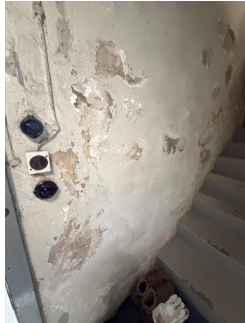
Treppenabgang zum Kellergeschoss mit Feuchtigkeitserscheinungen
