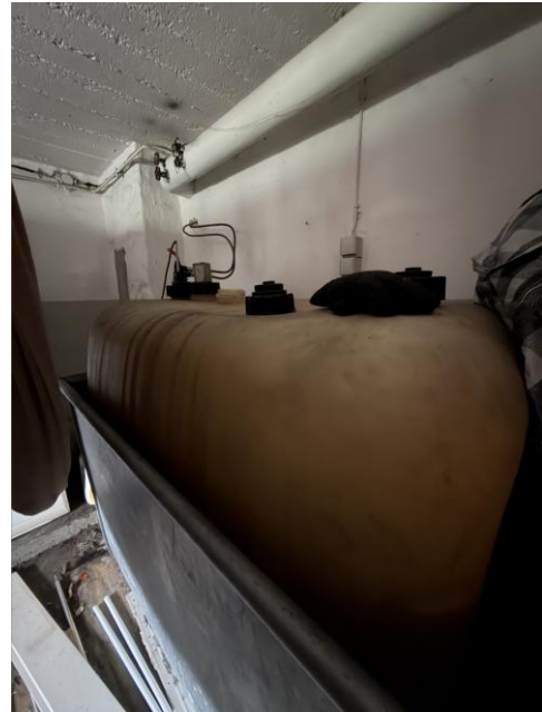
Öltanks im Kellergeschoss
