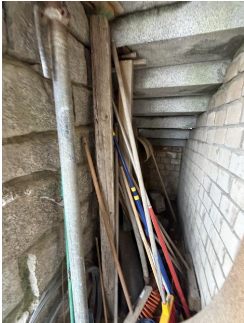
Abstützung Balkon Eingangsbereich
