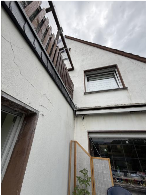
Putzabplatzungen und Risse an der Fassade
