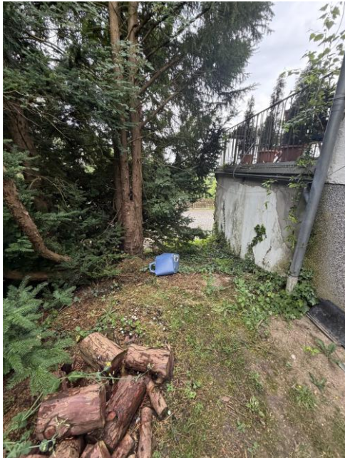
Feuchtigkeitserscheinungen im rückwärtigen Fassadenbereich am Balkon
