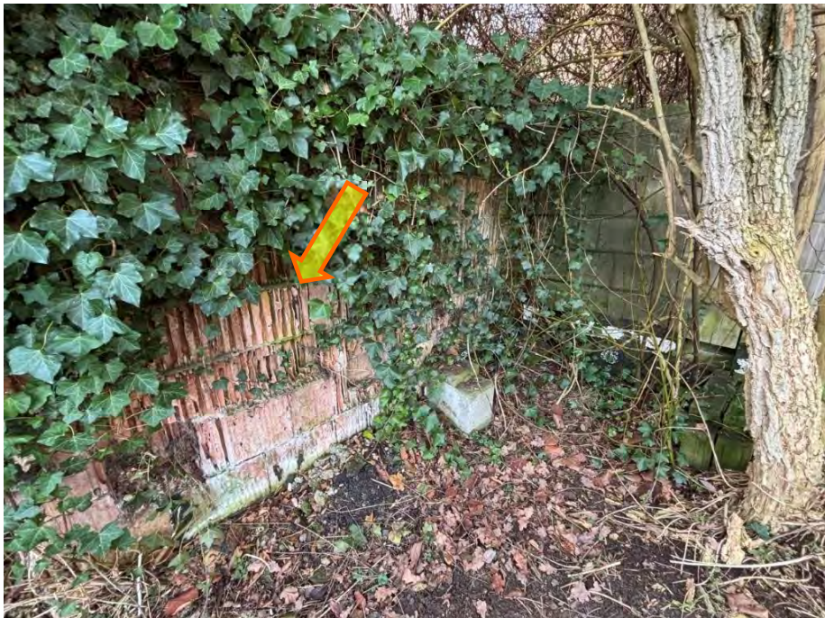
Marodes Mauerwerk (Beispiel)
