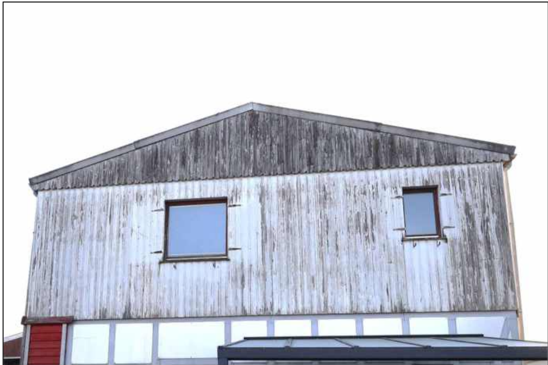
Abbildung 18 erhebliche Abwitterung der Holzfassade zur Straßenseite sowie fehlende Fensterläden Foto Nr. 6, fotografiert am 20.02.2026
