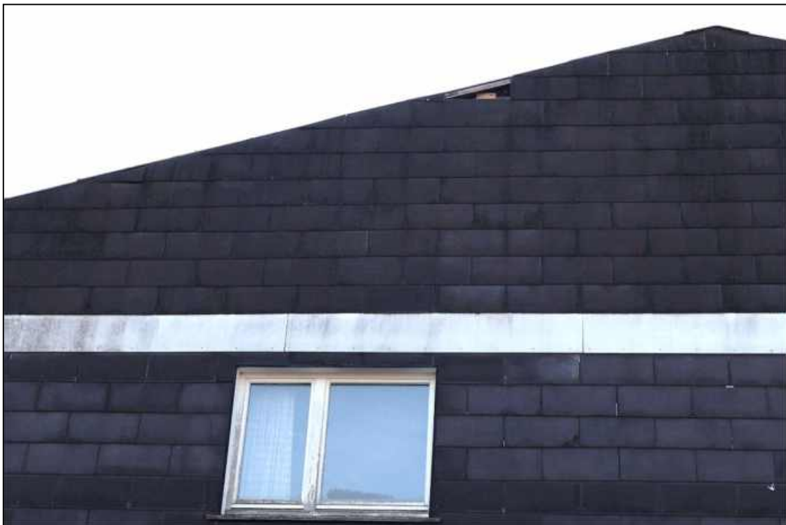
Abbildung 32 abgewitterte Holzfenster und Beschädigung der Außenfassade Foto Nr. 14, fotografiert am 20.02.2026
