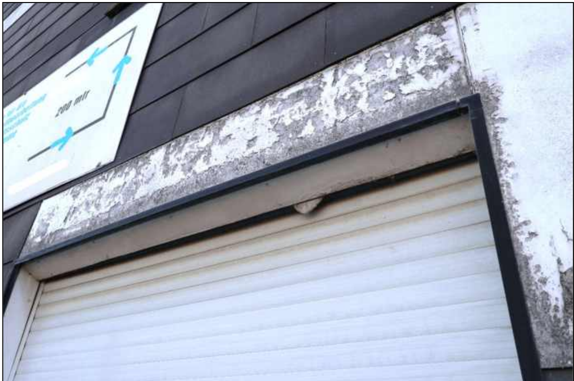
Abbildung 30 Abwitterung der Frontfassade und der Rolladenkästen Foto Nr. 12, fotografiert am 20.02.2026
