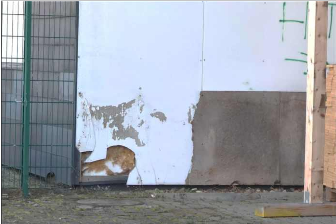
Abbildung 31 Beschädigung der Außenfassade zur Hofseite Foto Nr. 13, fotografiert am 20.02.2026
