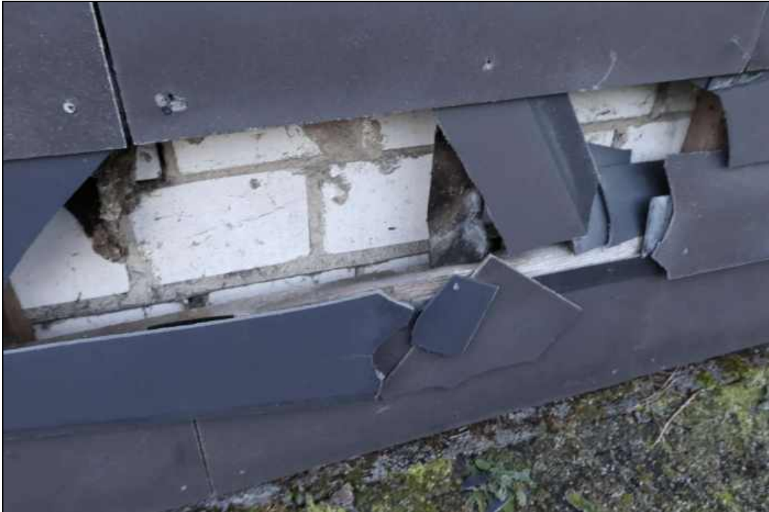
Abbildung 29 Beschädigung der Außenfassade Foto Nr. 11, fotografiert am 20.02.2026
