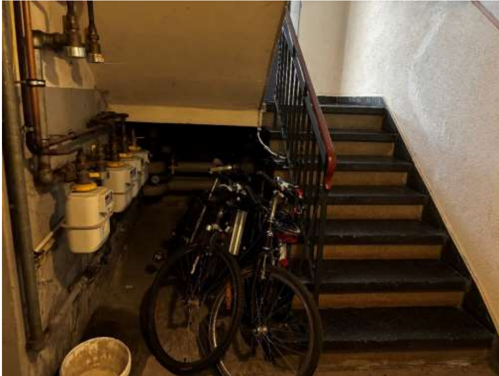
Treppe ins Kellergeschoss, Gasuhren
