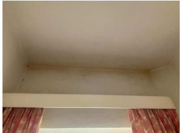
Verfärbungen im Bad
