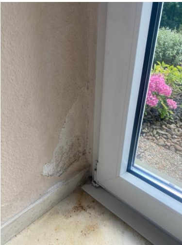
Putzschäden im Wohnraum, Keller
