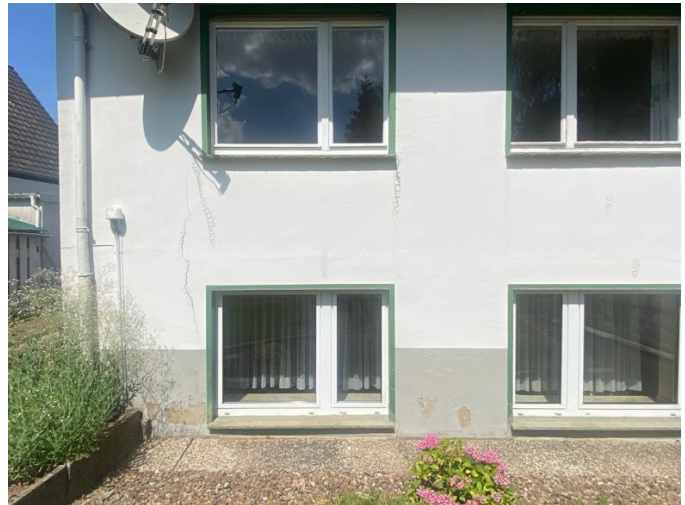
Rissbildung an Südfassade und im Sockelbereich
