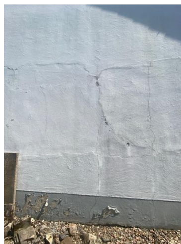
Putzschäden an Westfassade
