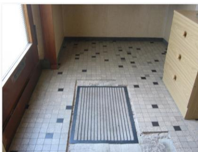
fehlende Mosaikfliesen im Flur
