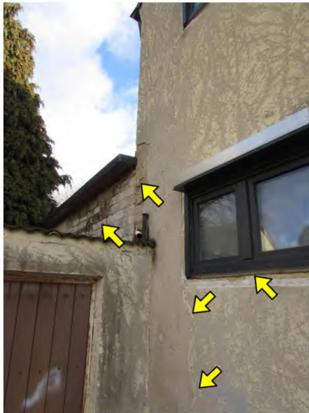
Foto 8: Wohnhaus-Anbau: tlw. fehlender Fassadenputz, fehlende Außenfensterbank, Risse
