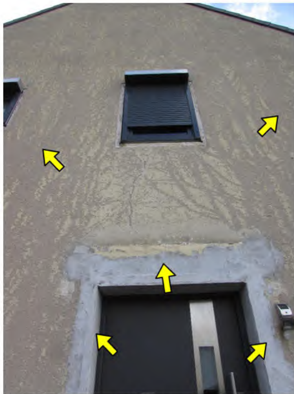
Foto 7: Wohnhaus: fehlender Farbanstrich, Putzschäden/Risse
