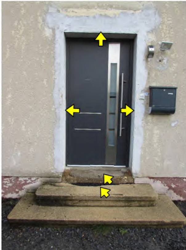
Foto 9: Hauseingang: nicht abschließende beigearbeitete Laibung, beschädigte Eingangstreppe, tlw. fehlender Belag
