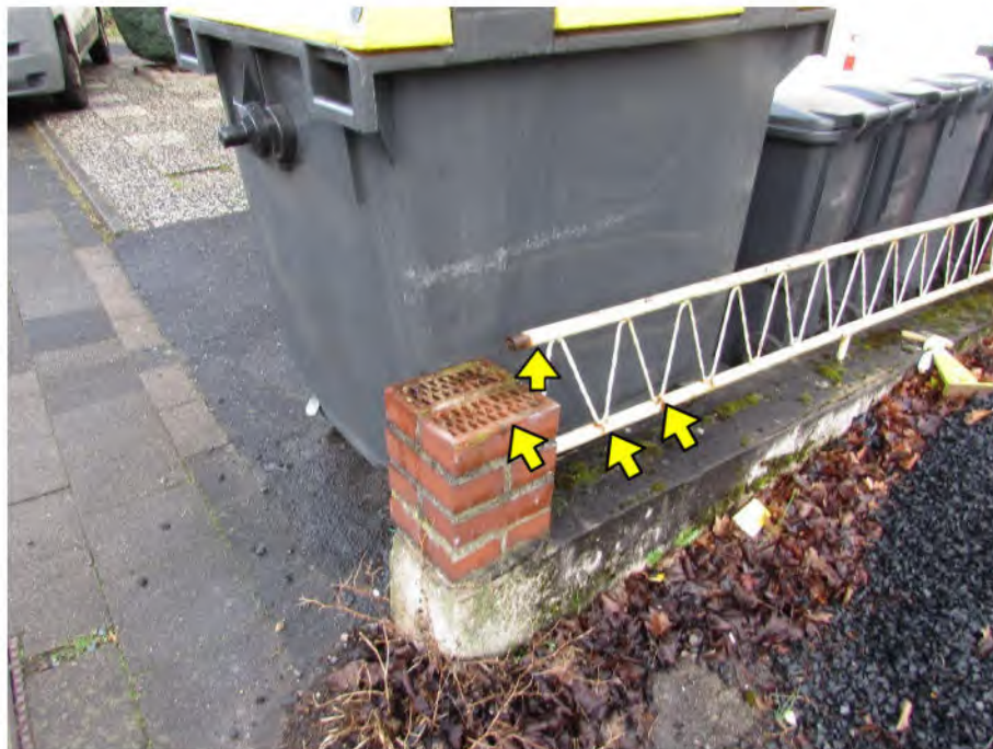
Foto 12: seitliche Einfriedung: beschädigte Mauerwerkspfeiler, korrodiertes Geländer
