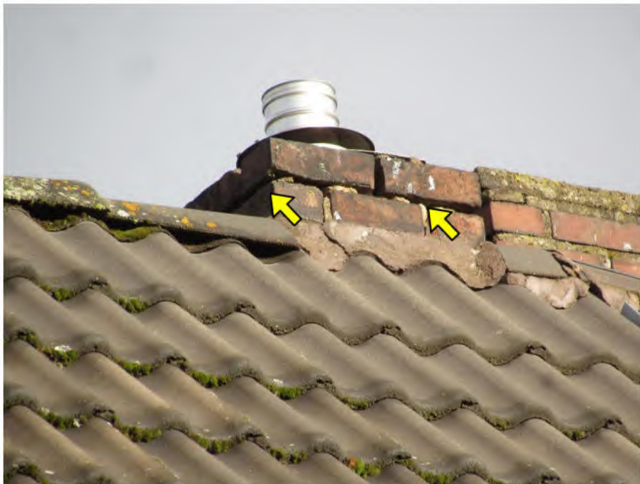
Foto 2: Wohnhaus: schadhafter Schornsteinkopf
