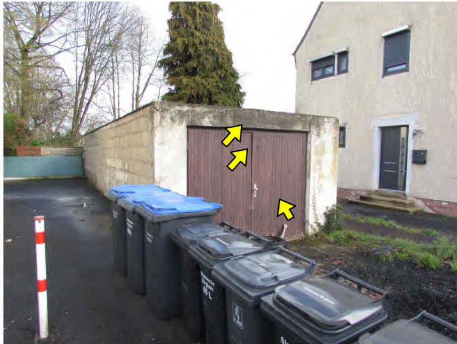
Foto 11: Garage: Feuchtigkeit im Sturzbereich, verwittertes, nicht dicht schließendes Holztor
