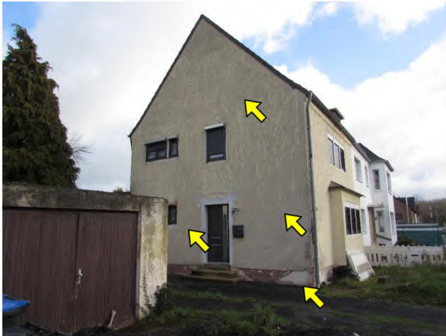
Foto 5: Wohnhaus: Schäden an der Fassade, fehlender Farbanstrich
