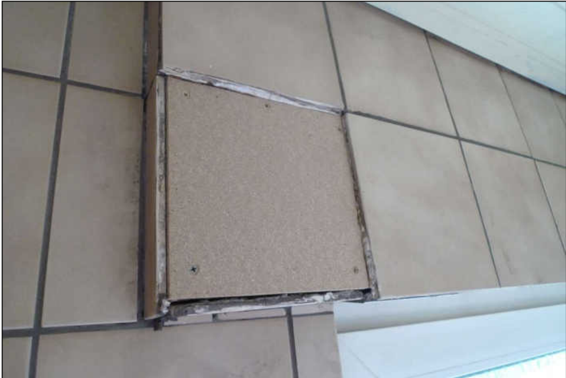
Abbildung 36 Beschädigungen der Wandfliesen im Bad im Obergeschoss fotografiert am 11.06.2025
