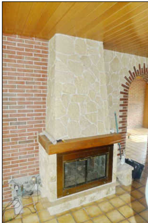
Abbildung 23 Kamin im Wohn- und Esszimmer im Erdgeschoss fotografiert am 11.06.2025
