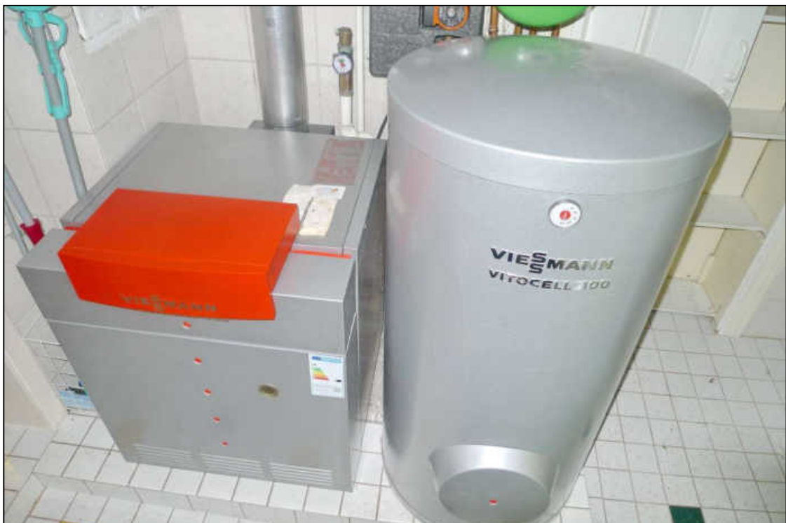
Abbildung 13 Heizungsanlage im Kellergeschoss fotografiert am 11.06.2025
