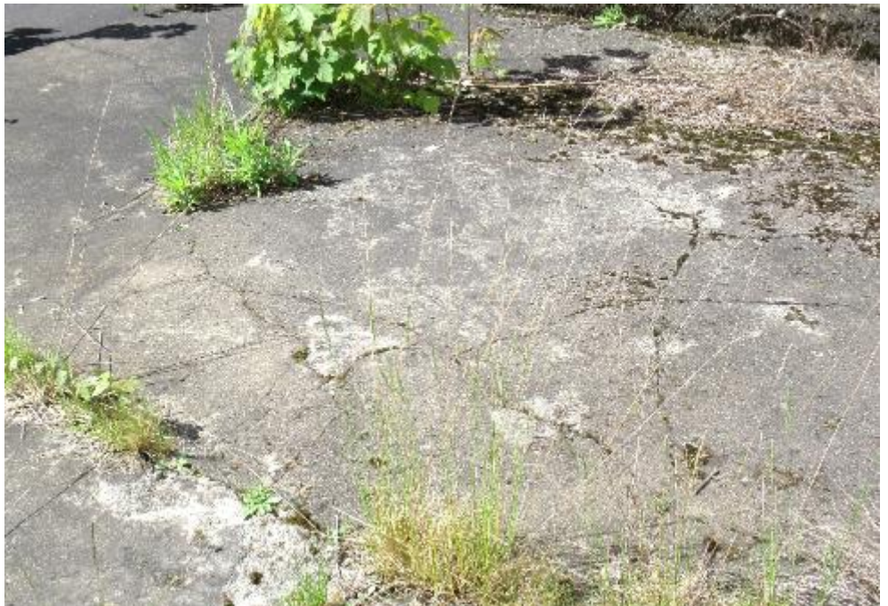
Rissbildung im Terrassenbereich
