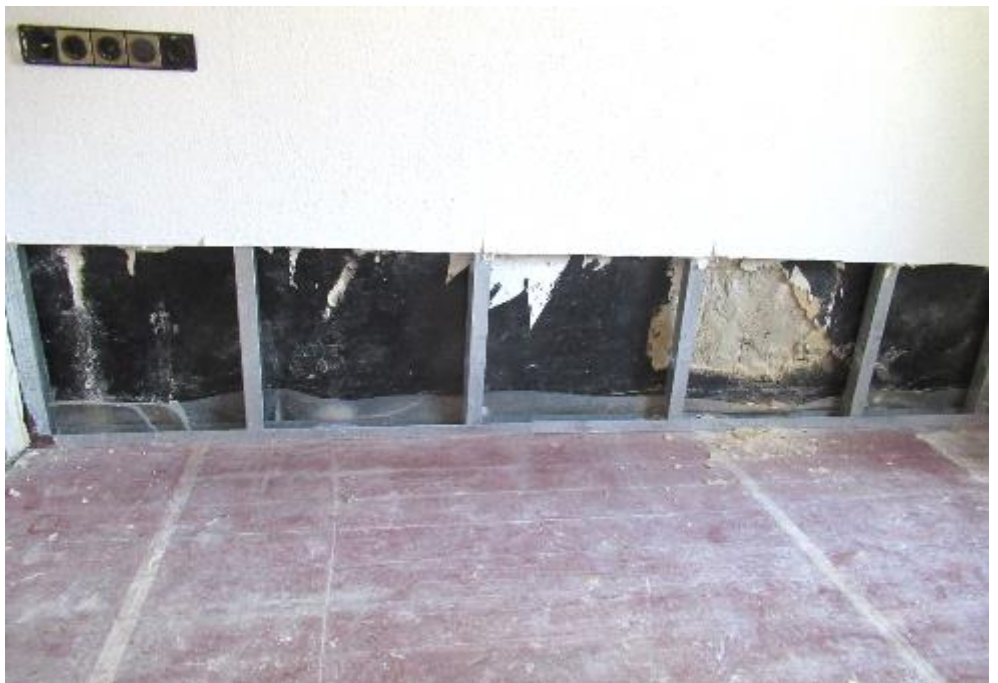
Schaden am Wandbereich im Schlafzimmer
