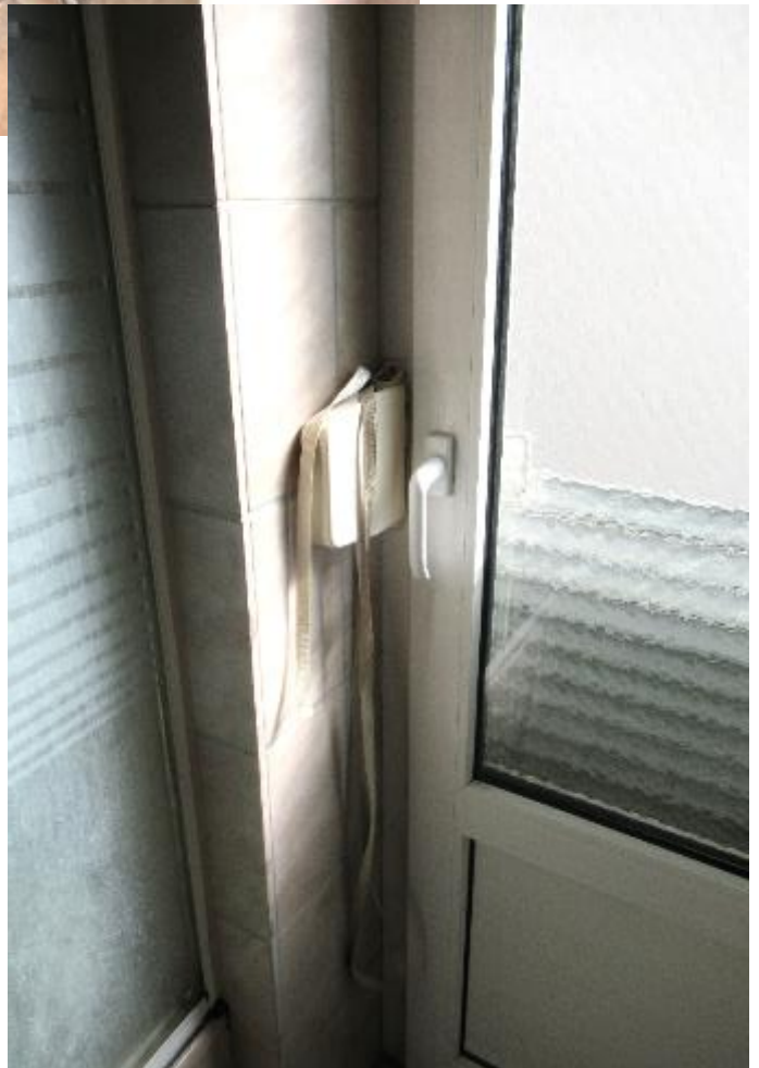
defekte Rolllade im Bad
