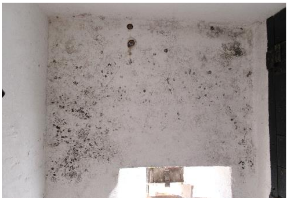
Schimmelbildung im Bereich des Kellerabgangs
