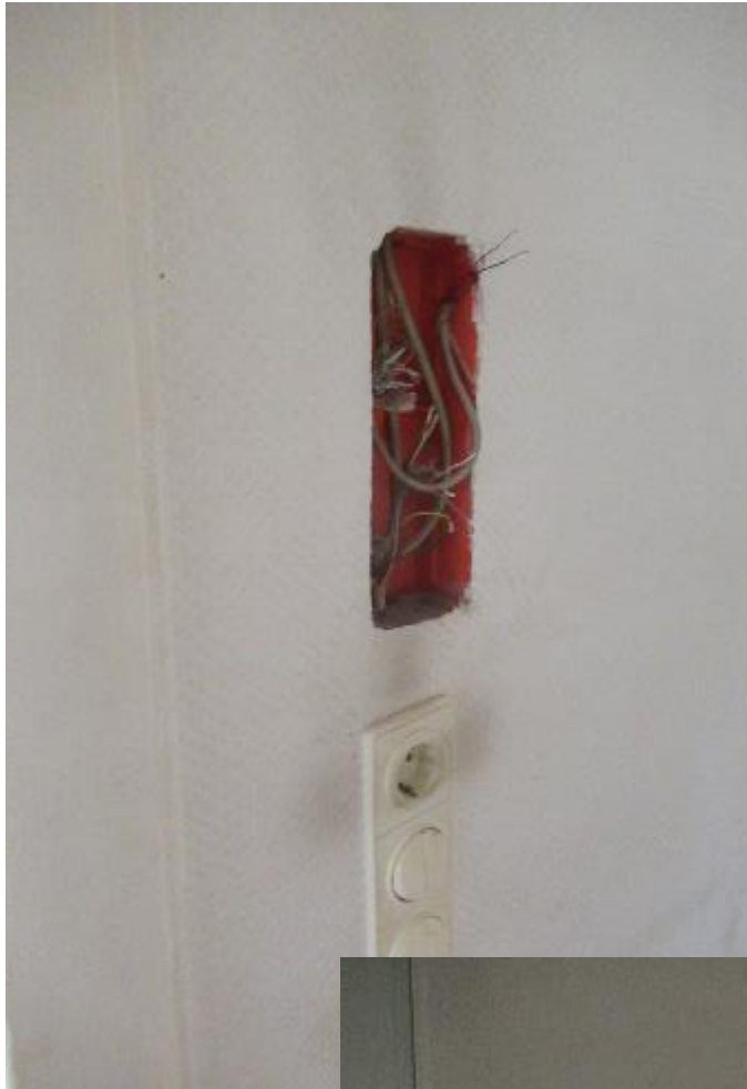
fehlende Sprechanlage im Flur
