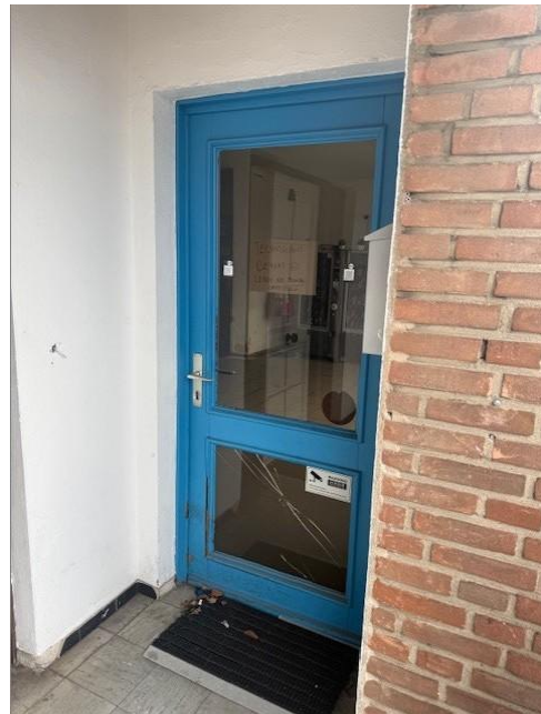
Bild 4: Eingang Ladenlokal (Tür schadhaft)
