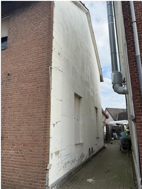
Bild 5: Außenansicht Giebelseite, Risse
