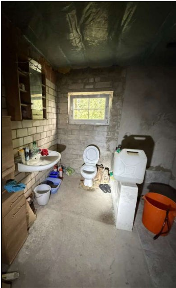
provisorisches Bad ohne Funktion (kein Wasseranschluss, keine sachgerechte Entwässerung)
