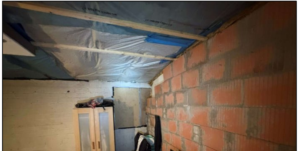
rückwärtiger provisorischer Aufenthaltsraum (u.a. fehlendes Fenster)
