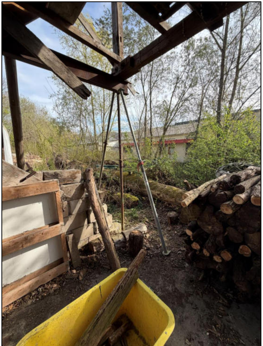
Detailansicht maroder Schuppen; provisorische / nicht ordnungsgemäße Abstützung durch Baustützen
