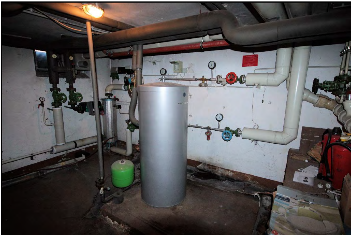
Bild 17: Fernwärme-Heizungsanlage im Kellergeschoss
