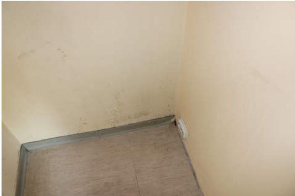
Bild 39: Feuchtigkeitseinwirkungen im Eckbereich
