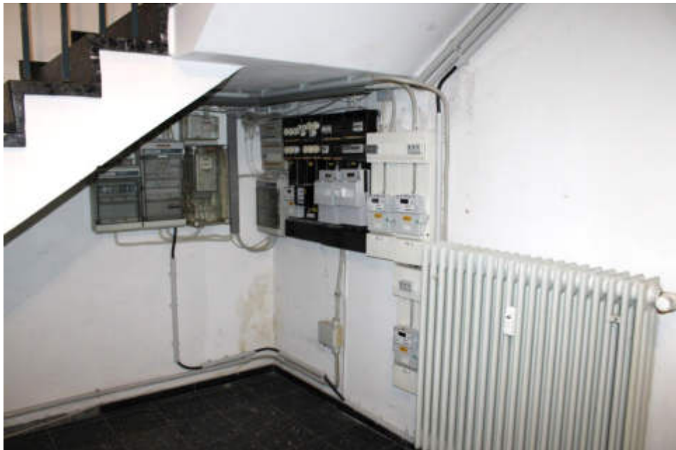
Bild 14: Treppenhaus Kellergeschoss / Elektrounterverteilungen Feuchtigkeitseinwirkungen im Eckbereich
