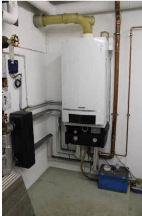
Bild 17: Hausanschlussraum Heizung KG / Versorgungsanschlüsse
