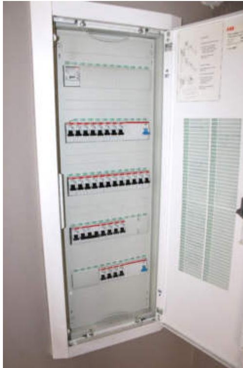
Bild 65: Elektrounterverteilung Büro DG
