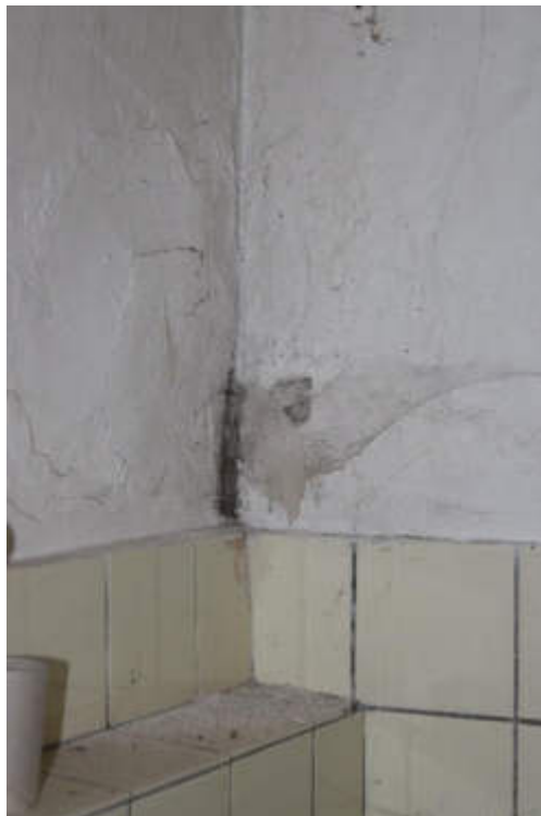
Bild 20: Detailfoto Feuchtigkeitseinwirkungen im Eckbereich
