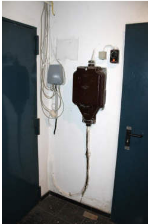
Bild 15: Kellerflur zum Treppenhaus / Versorgungsanschlüsse Feuchtigkeitseinwirkungen im Sockelbereich
