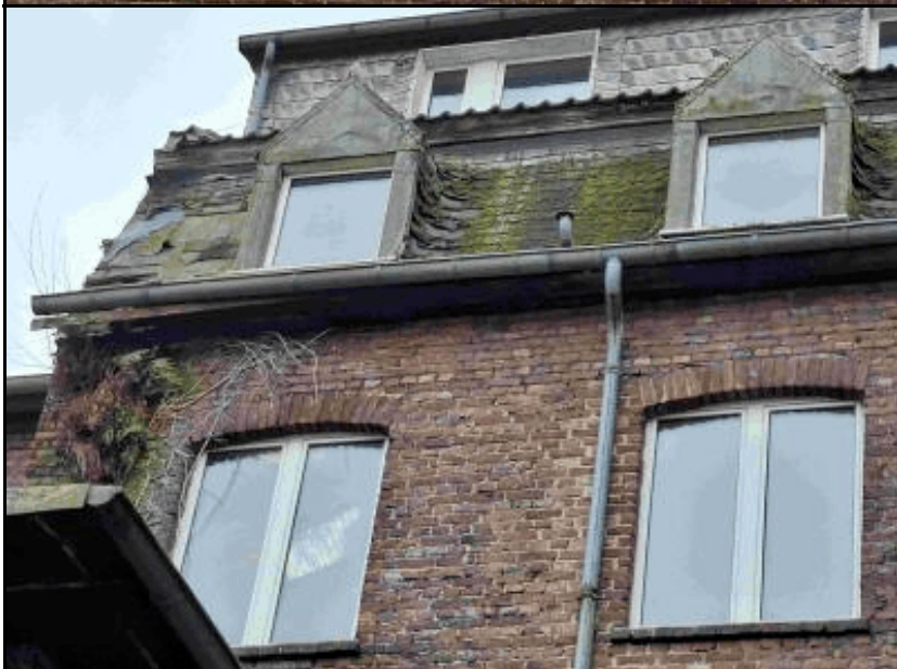
Foto 9: Zustand Dacheindeckung hinten
