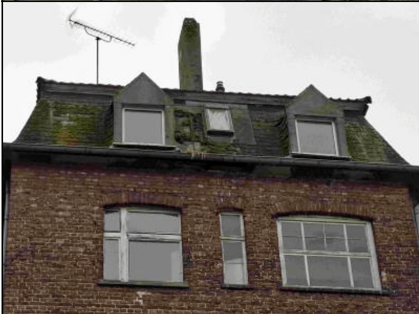
Foto 8: Zustand Dacheindeckung hinten
