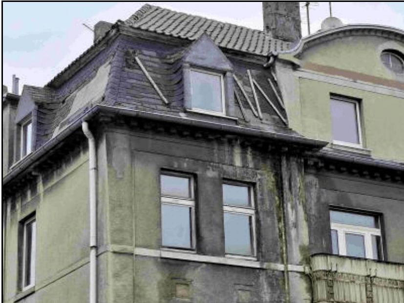
Foto 7: Zustand Dacheindeckung vorn
