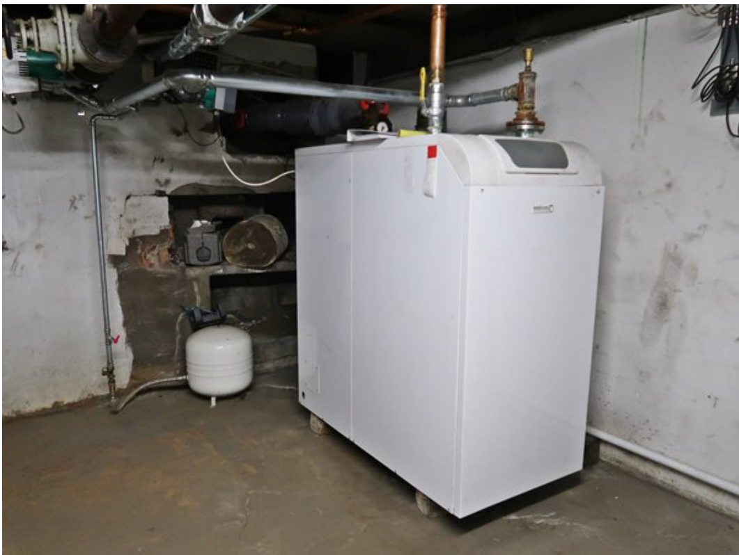
Gasheizkessel zur Heizungsversorgung der Häuser Heinrich-Gustav-Straße 116-124
