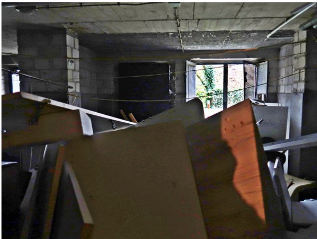
Kellerraum mit Sperrmüllablagerungen
