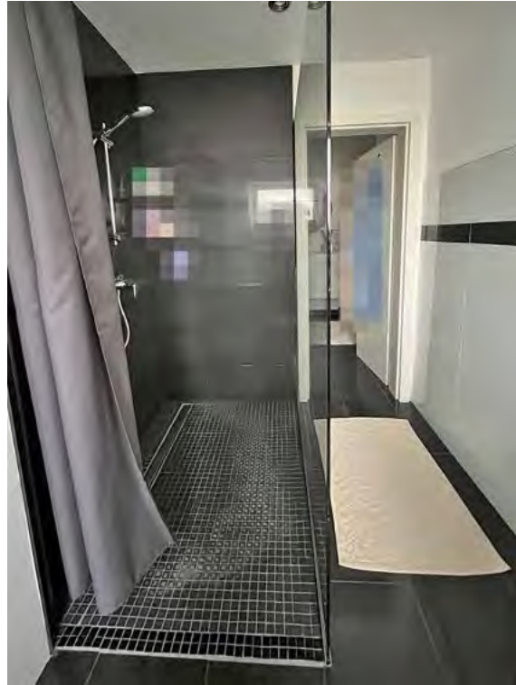
bodengleiche Dusche mit Ausblühungen
