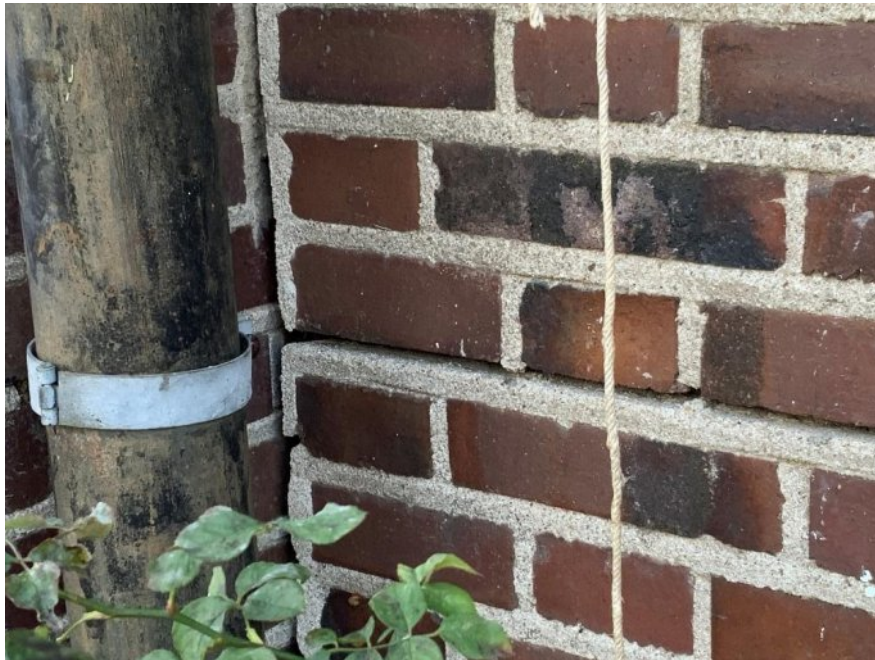
Bild 19: (Setzungs-)Riss/offene Fuge (Mauerwerksanschluss Wohnhaus-Balkonanbau)
