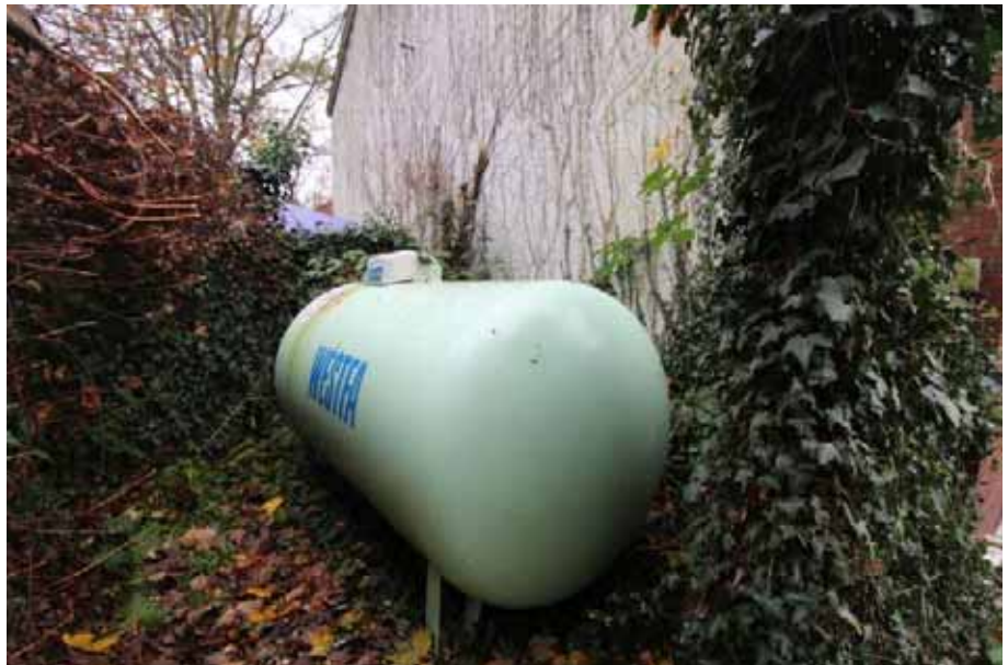
Sicht auf den Flüssiggastank
