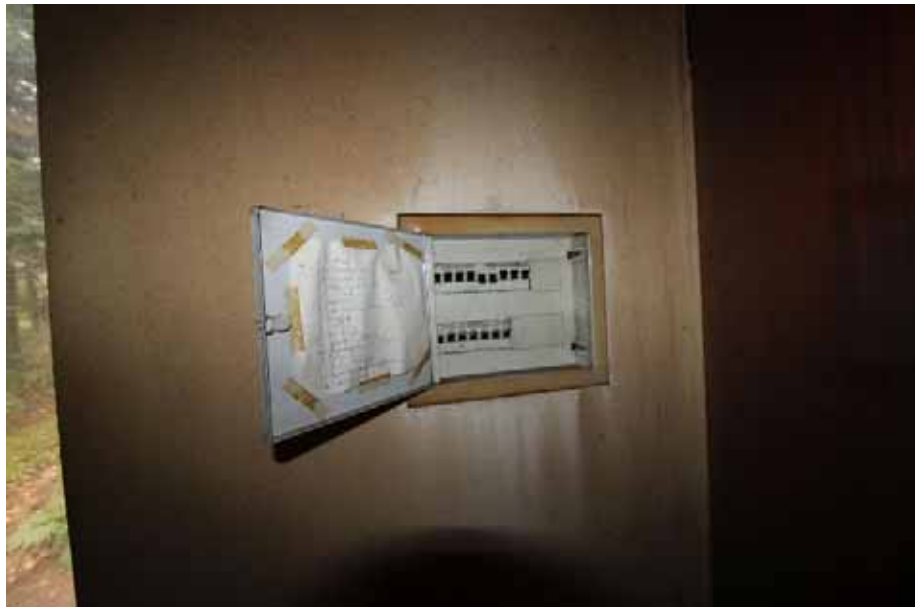
Sicht in einen Siche- rungskasten / EG
