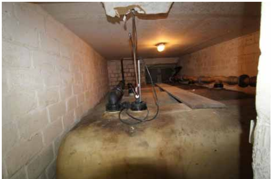
Sicht in den Öltankkellerraum / KG
