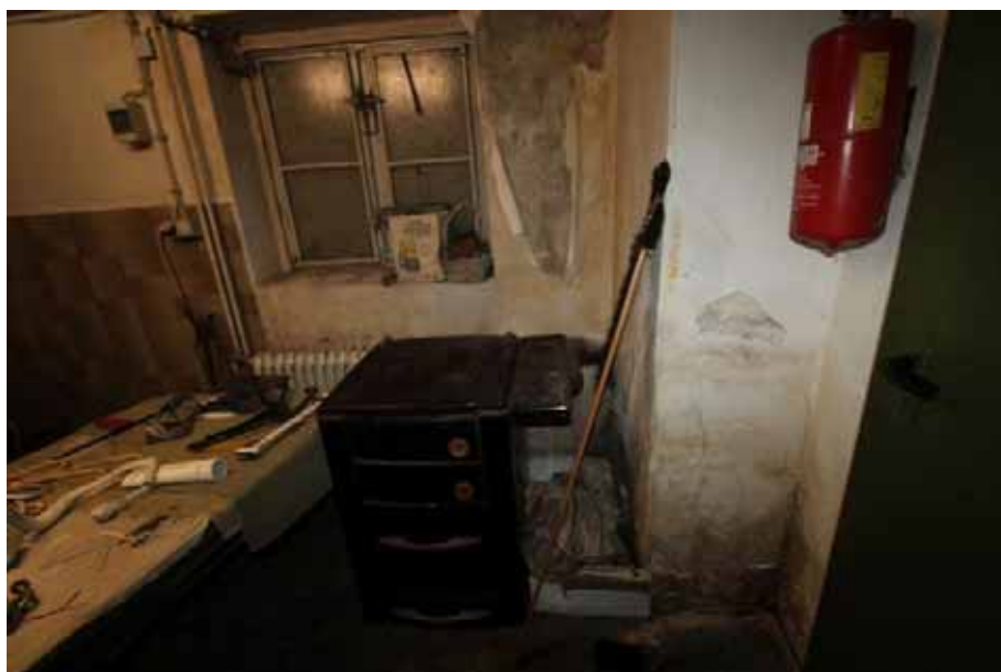
Sicht auf die Feuch- tigkeit im Bereich Kel- lermauerwerk/Kamin / KG
