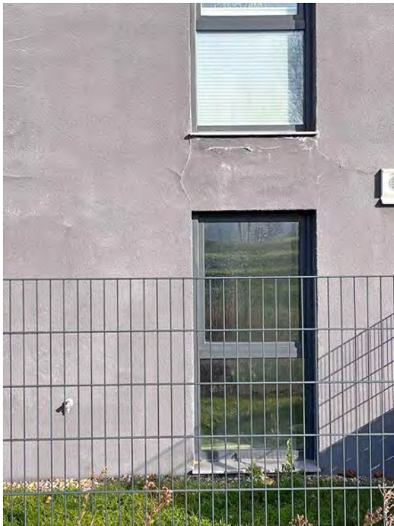
Detailansicht Schäden am WDVS
