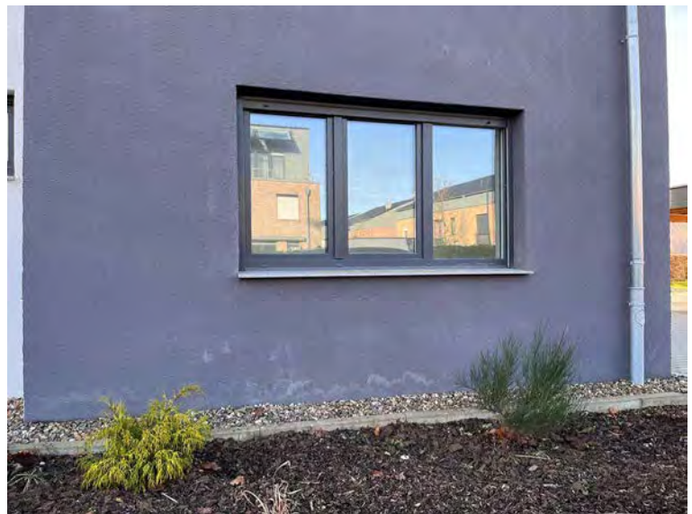
Feuchtigkeitsschäden im Sockelbereich des WDVS (exemplarisch)
