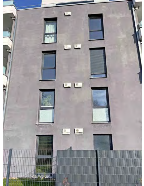
Teilansicht von Südwesten mit Rissbildung im WDVS
