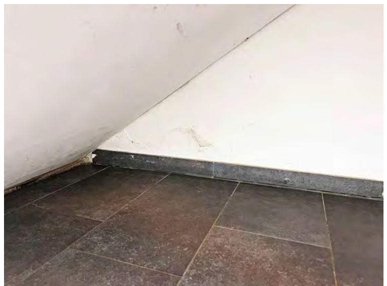
Feuchtigkeitsschäden unter der Treppe im Erdgeschoss
