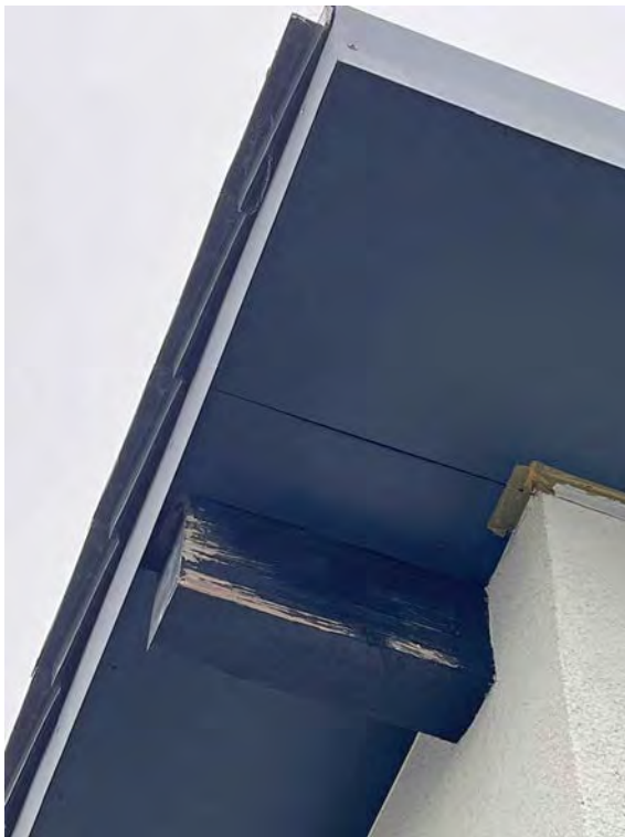
ungeschützte, abgewitterte Balkenköpfe des Pultdachs
