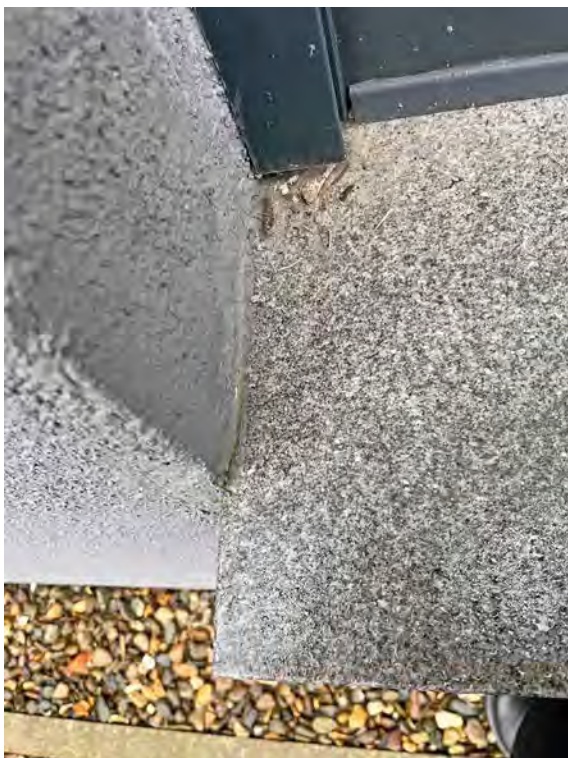
mangelhafte Putzüberdeckung im Bereich der Natursteinfensterbank (exemplarisch)
