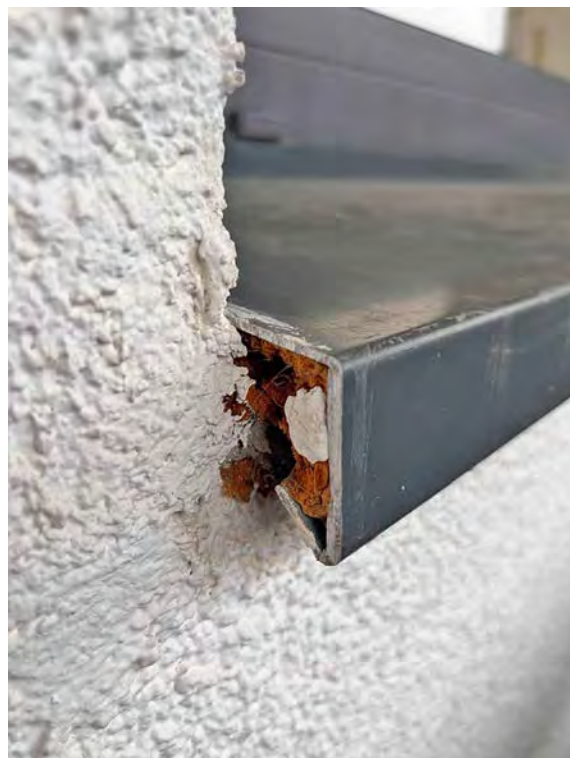
mangelhafte Putzüberdeckung und unsauberer Abschluss im Bereich der Aluminiumfensterbank (exemplarisch)
