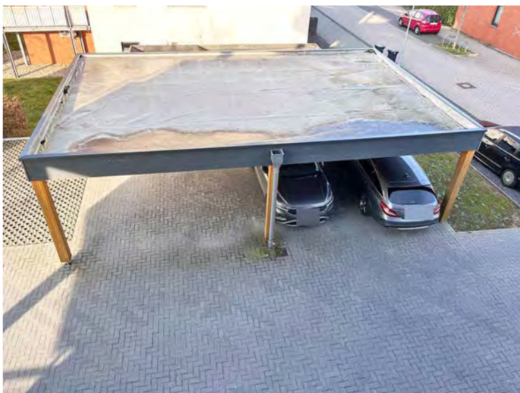
Foliendach Carport, Falten- und Pfützenbildung, vermutlich Beschädigungen im Eckbereich
