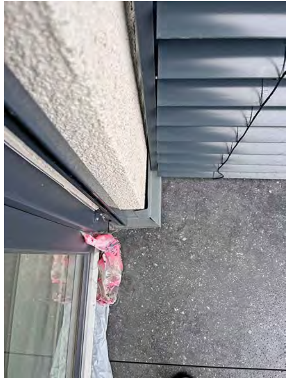
mangelhafter Sockelanschluss (exemplarisch)
