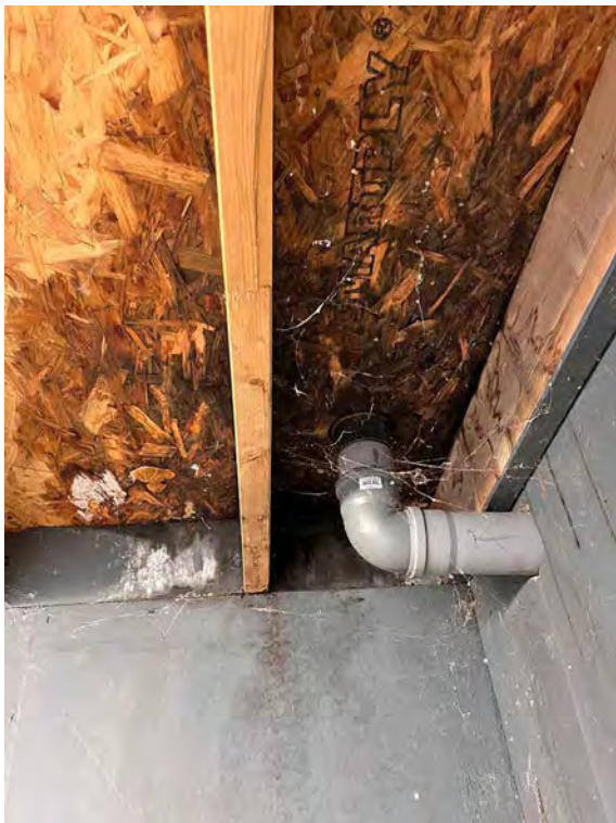
Feuchtigkeitsschäden am Dach des hinteren Fahrradschuppens
