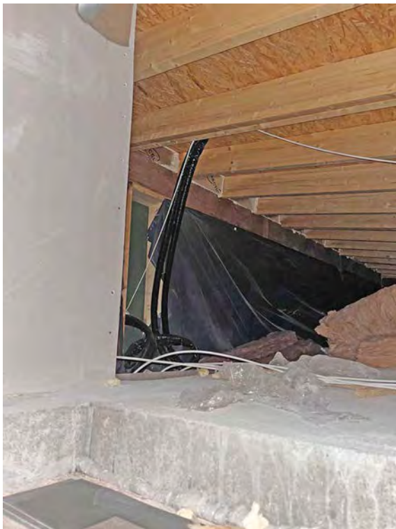
Speicherraum Staffelgeschoss, verschobene Dämmung, abgerissene Folie
