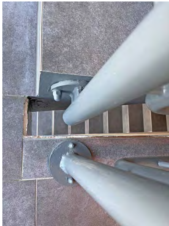
unsaubere Ausführung Treppenaug und Anstrich Geländer (exemplarisch)
