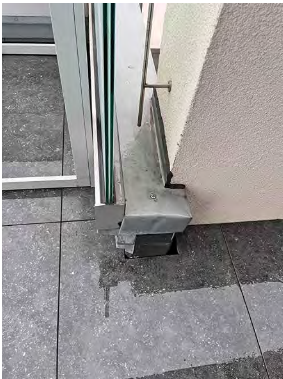
mangelhafte Ausführung der Brüstungsabdeckung im Staffelgeschoss (exemplarisch)
