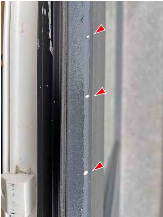
Fehlstellen in der Folierung der Fenster (exemplarisch)
