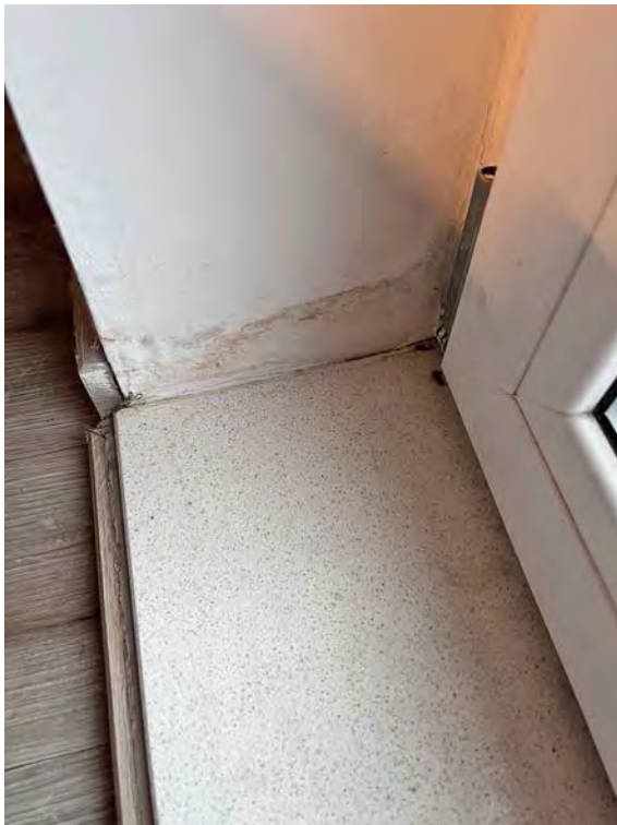
Feuchtigkeitsschäden im Leibungsbereich
