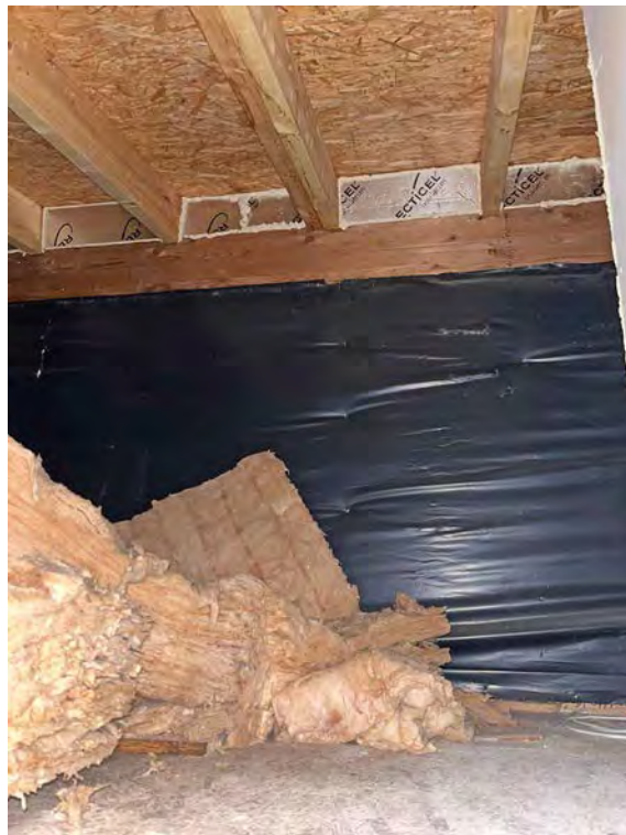
Speicherraum Staffelgeschoss, verschobene Dämmung
