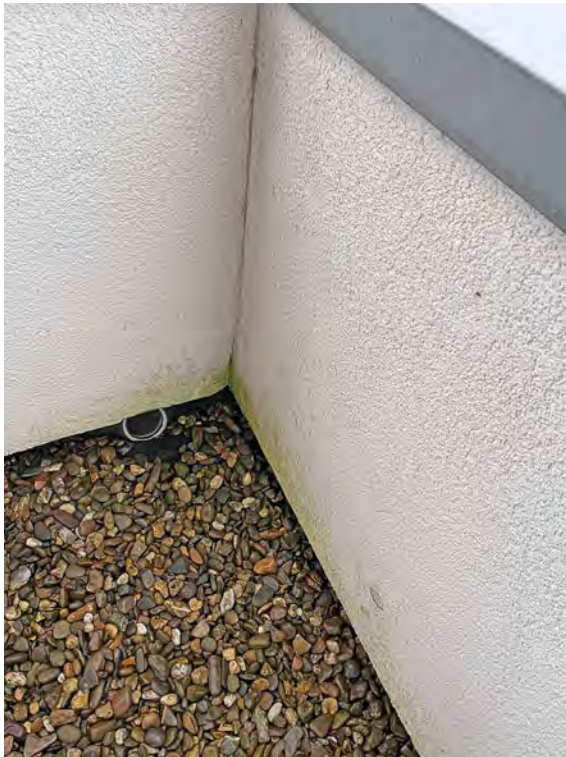
mangelhafte Entwässerung der Dachterrasse
