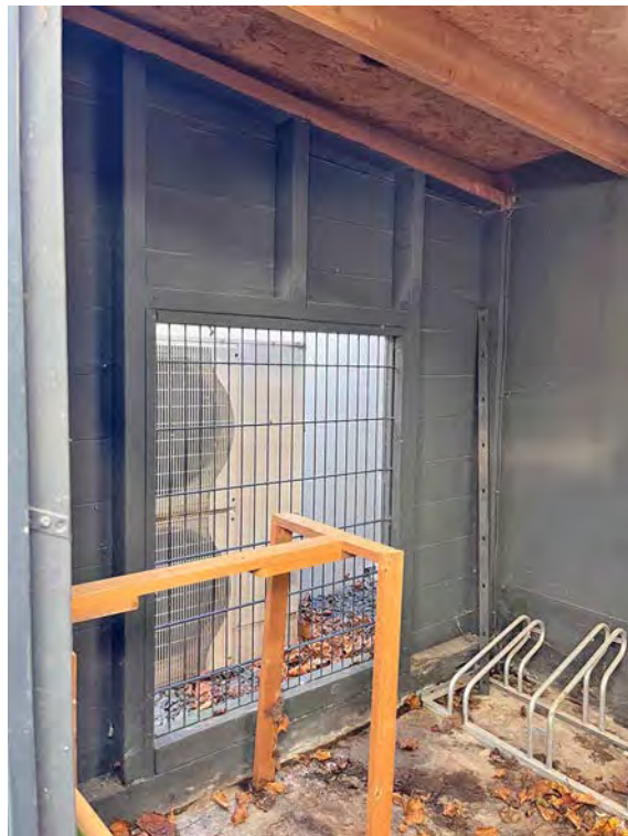
marode Sockelbalken im hinteren Fahrradschuppen
