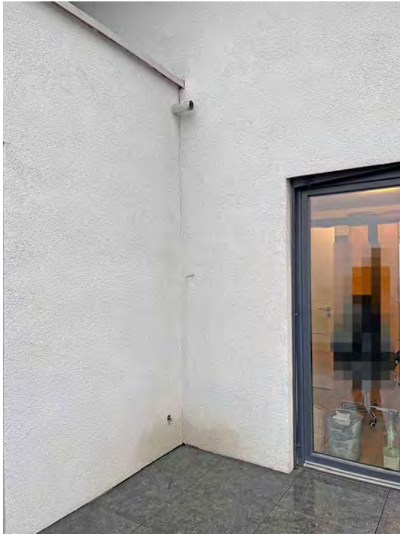
freie Entwässerung des Flachdachs auf die Dachterrasse und offene Elektro-Klemmdose
