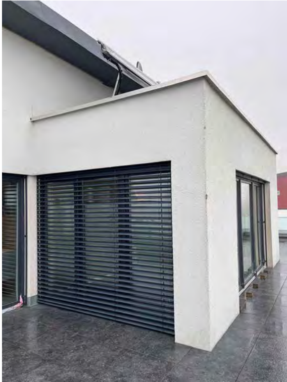
Dachterrasse, fehlende Entwässerungsrinnen vor den Fenstern
