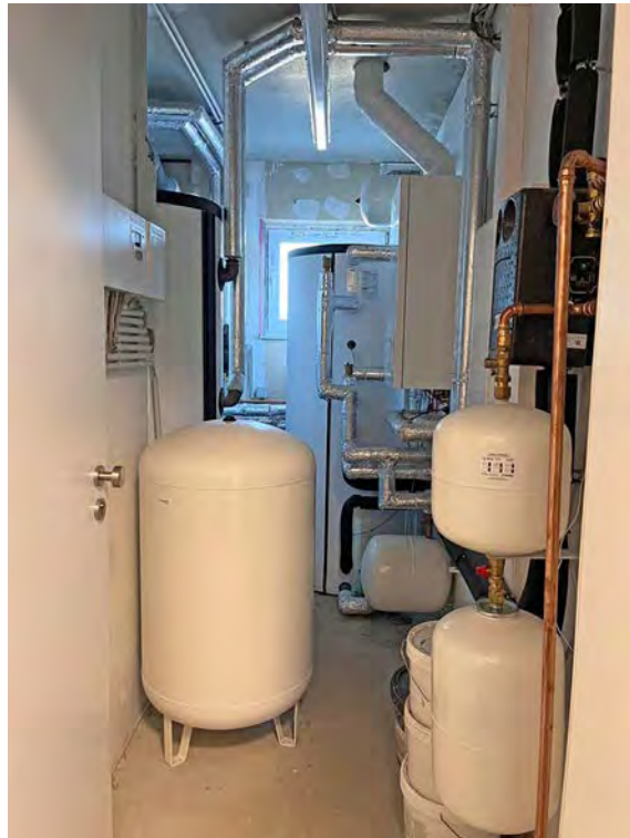
Technikraum im Staffelgeschoss
