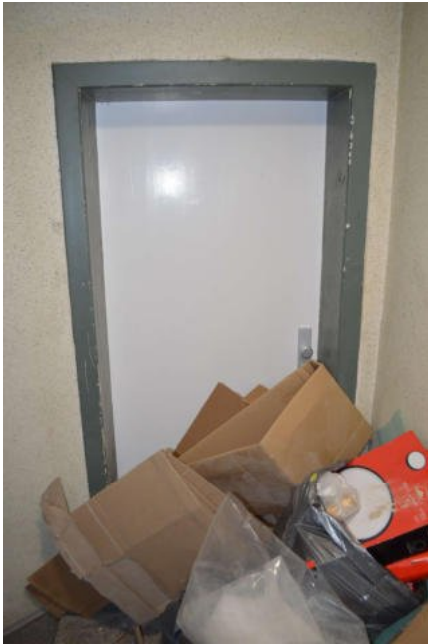
Bild 9: Eingangstür Trockenboden ETW Nr. 15
