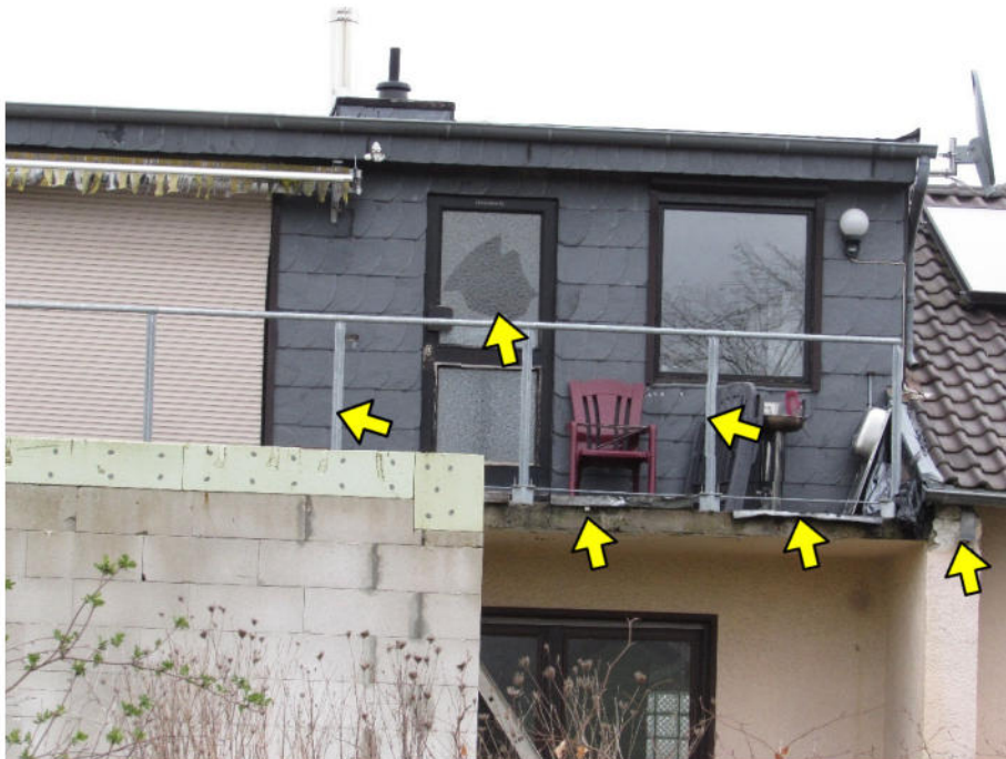
Foto 10: Wohnhaus, Balkon: beschädigte Glasscheibe der Außentür, beschädigte Markise, nicht ordnungsgemäßer Abschluss der Balkonplatte, fehlende Geländerausfachung, Putzschäden im Fassadenbereich
