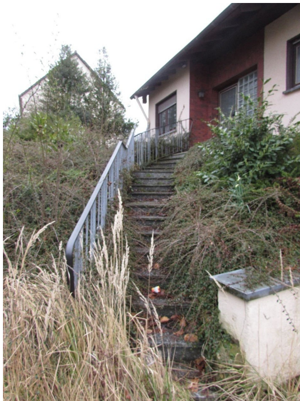
Foto 2: Hauszugangstreppe, verwilderte Eingrünung
