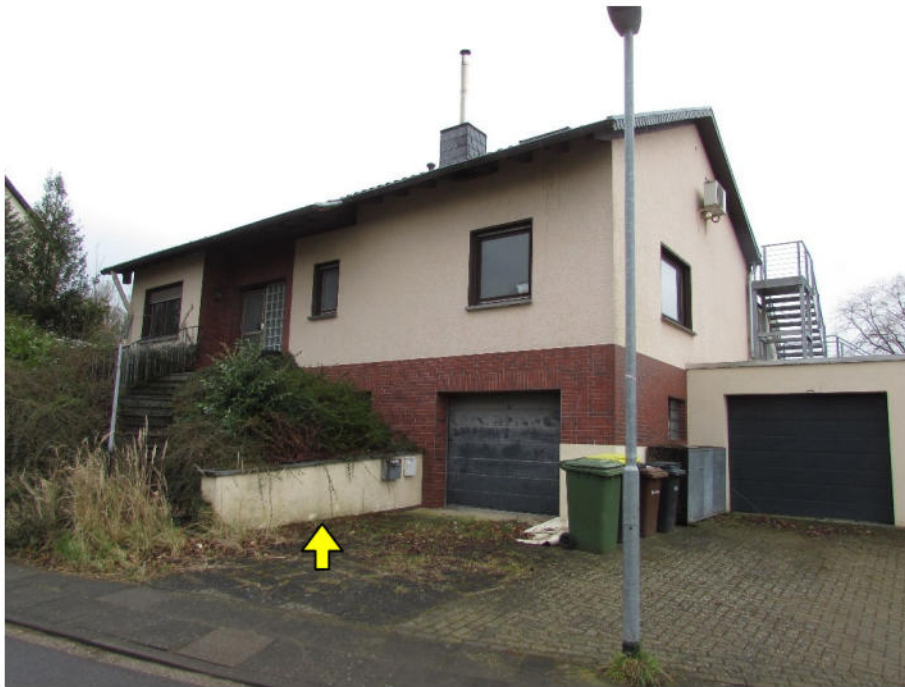
Foto 3: Wohnhaus, Ansicht von der "Weidenstraße": fleckige Stützmauer seitlich der Zufahrt
