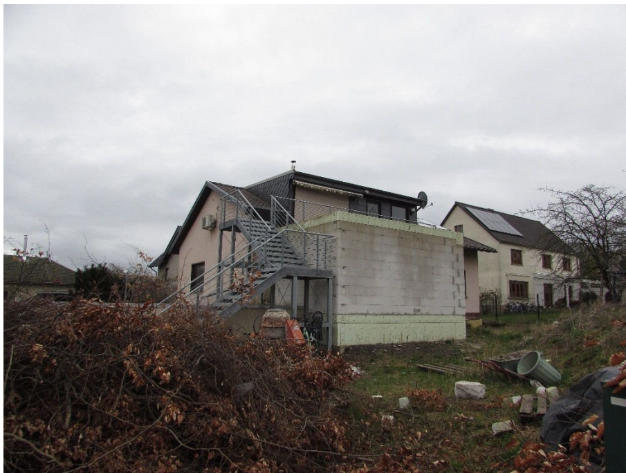
Foto 8: Wohnhaus mit nicht fertiggestelltem Anbau, Ansicht von der "Merzbacher Straße", Holzreste, Unrat
