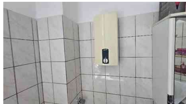
WE 68.3; Elektr. Durchlauferhitzer im Bad/WC.
