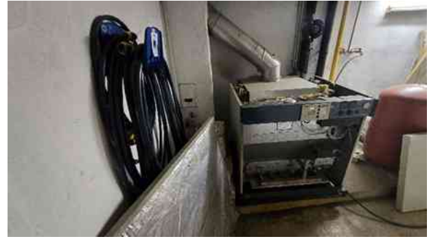
S50, KG; Zentraler Gas-Heizkessel für die Mehrfamilienhäuser Saarbrücker Str. 48, 50 und Achternbergstr. 68.
