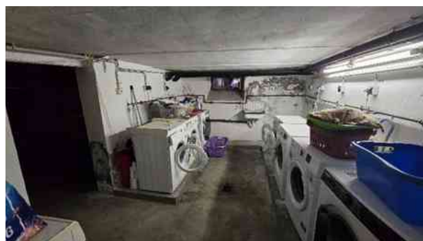
S50, KG; Waschkellerraum mit Feuchtigkeitsschäden an den Wänden.
