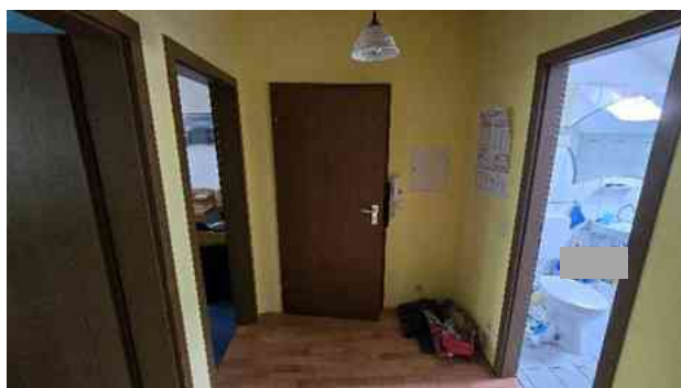
WE 50.5; Diele mit Blick auf die Türanlagen und die Elektrounterverteilung.
