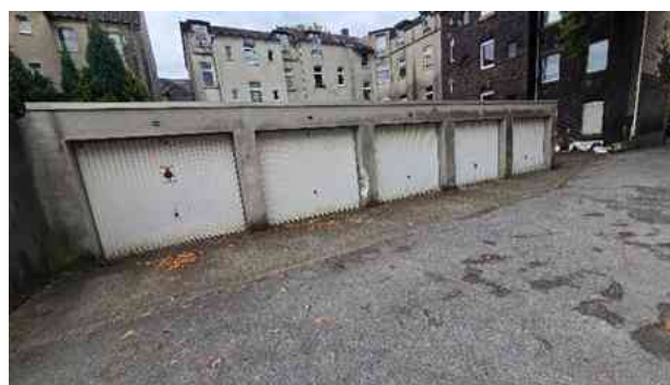
Blick auf die Garagenanlage mit Fassadenschäden. Der Baukörper überbaut im Bereich der Garagenzufahrten geringfügig (2,5 – 3m²) auf das Erschließungsgrundstück.
