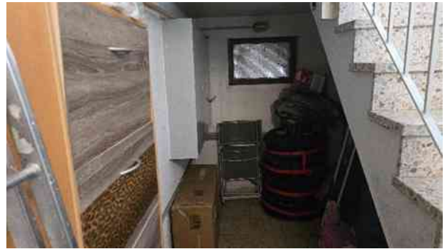
A68; Treppenhaus im KG mit Zählerschrank.
