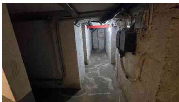
S50, KG; Kellerflur mit HAK Strom.
