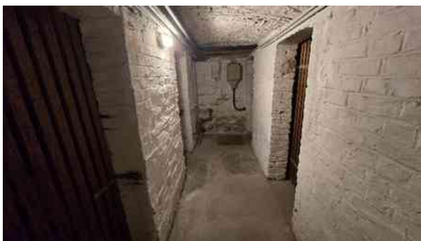
S48, KG; Kellerflur mit HAK Strom und zentralem Wasserzähler.
