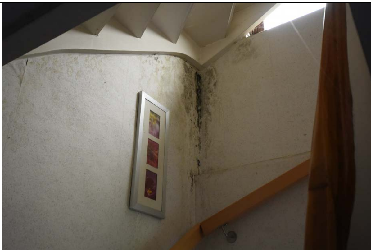
Bild 6 Treppenhaus im Wohnhaus mit starkem Schimmelbefall
