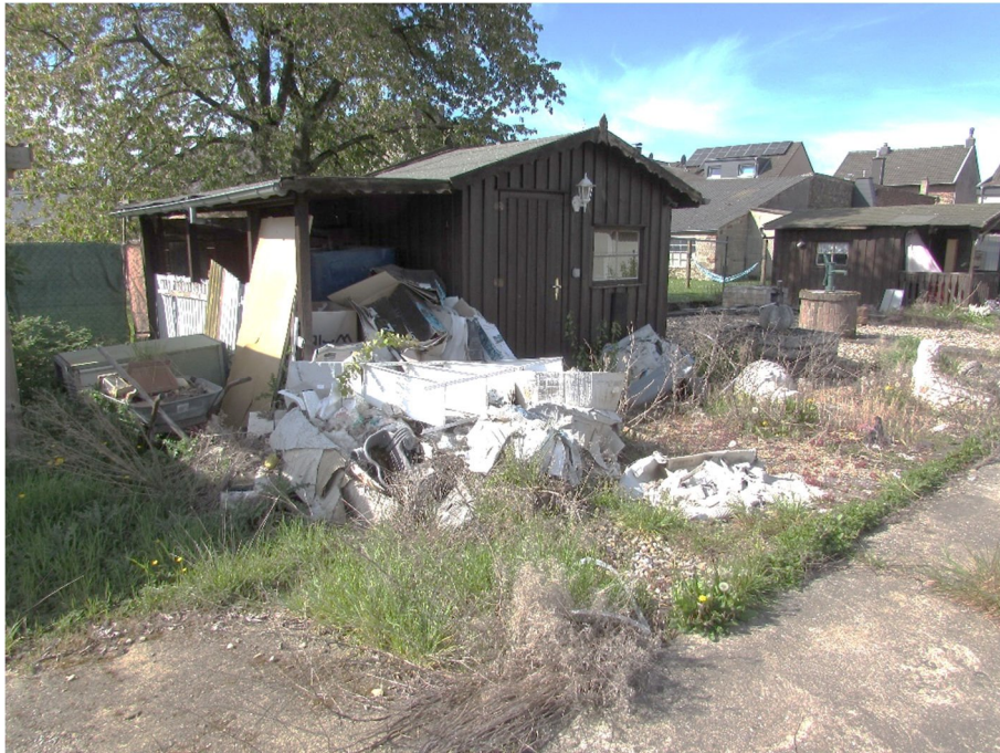
Foto 7: zweites, verwittertes Holzgartenhaus, Unrat
