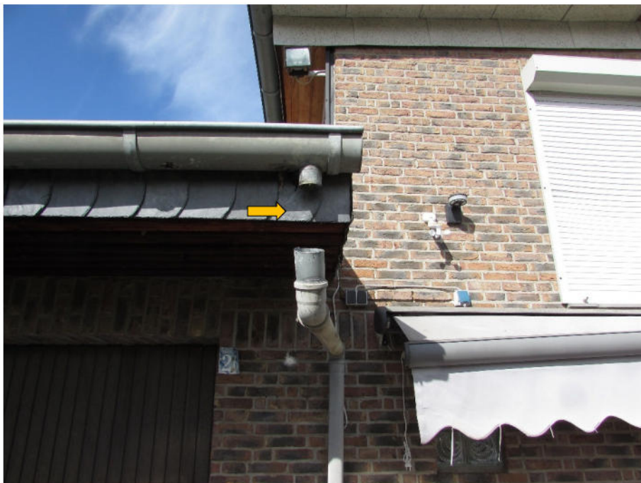
Foto 12: Wohnhaus, gelöste Verbindung der Dachentwässerung
