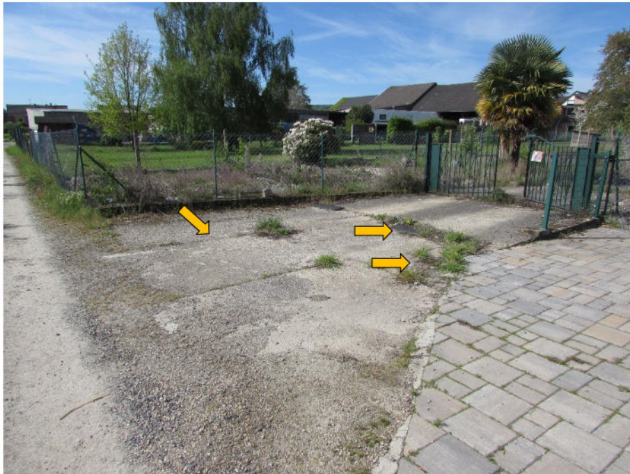
Foto 3: rückwärtige Zufahrt von Wirtschaftsweg aus, beschädigter Betonboden
