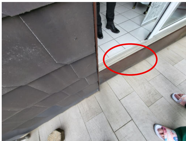
zu niedrige Schwelle am Ausgang zum Balkon
