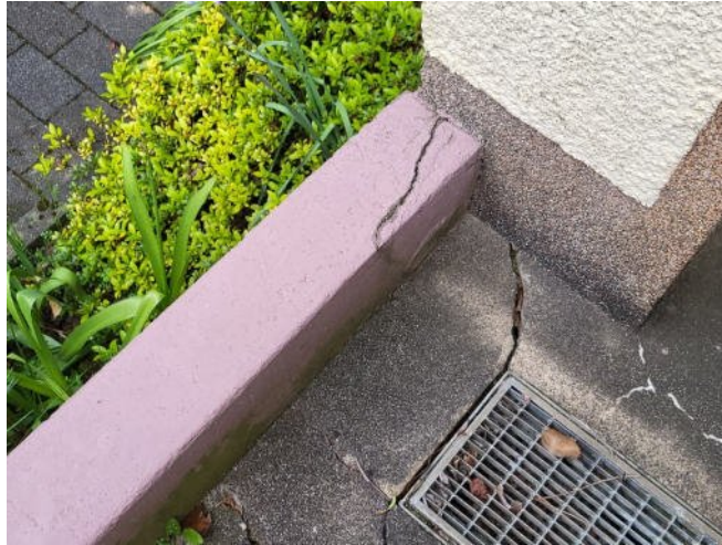
Stützmauer zum Nachbargrundstück gerissen
