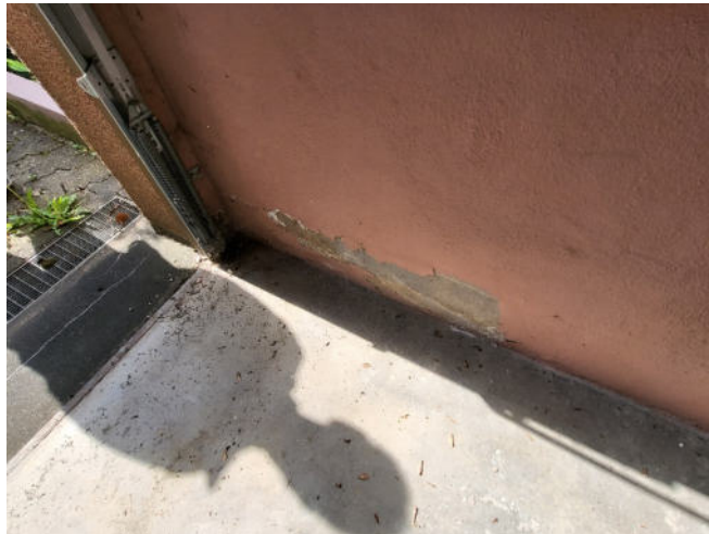
Feuchtigkeitsschaden in der Garage (zum Nachbargrundstück)
