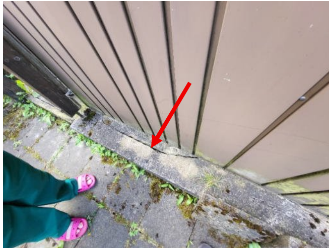
Fundament mit Rissen am Geräteschuppen
