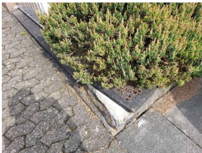
beschädigte Kante Stützmauer Vorgarten
