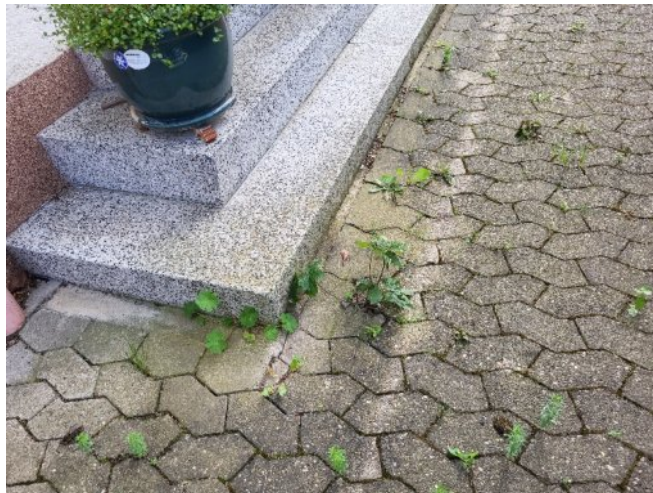
Unebenheiten im Betonsteinpflaster (Einfahrt)
