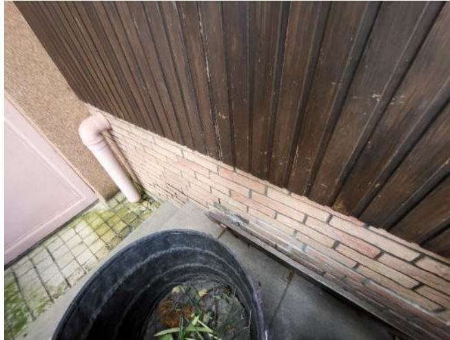
beschädigte Riemchen am Garagensocken (Gartenseite)
