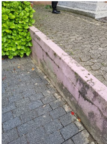
Stützmauer zum Nachbargrundstück verformt und gerissen
