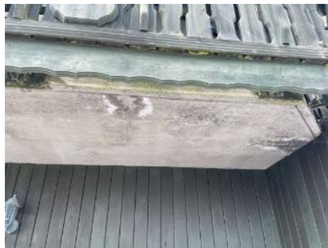
Feuchtigkeitsserscheinungen an der Betonplatte der Loggia vorn
