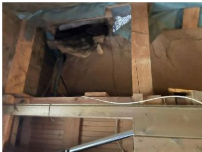
Loch in der Decke im Dachgeschoss des Anbaus
