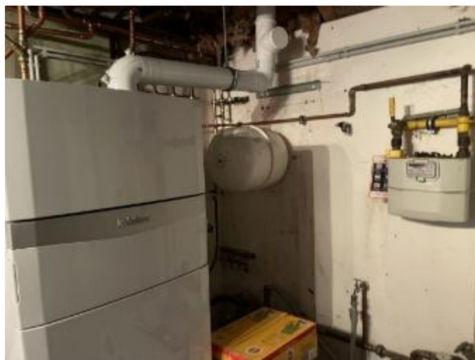
Heizung im Zwischenbau (Durchgang zur Wohnung im Anbau)
