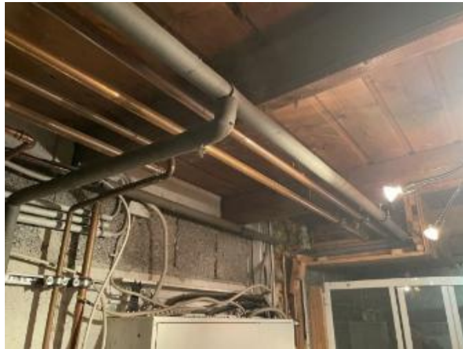
Freiliegende Leitungen im Heizungsraum (mit Dusche)
