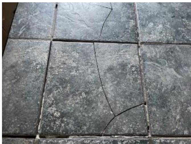
Fliesenschäden in der Wohnung im EG des Haupthauses
