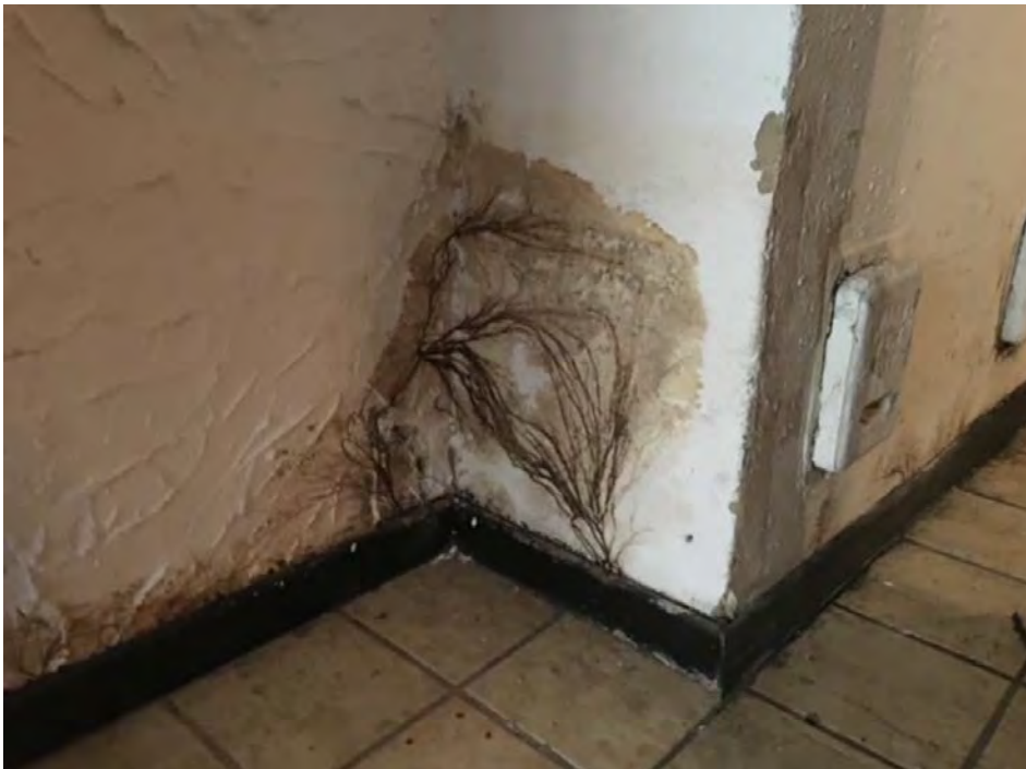
Abbildung: Foto des Schwammbefalls 2021 (zwischenzeitlich oberflächlich gereinigt)
