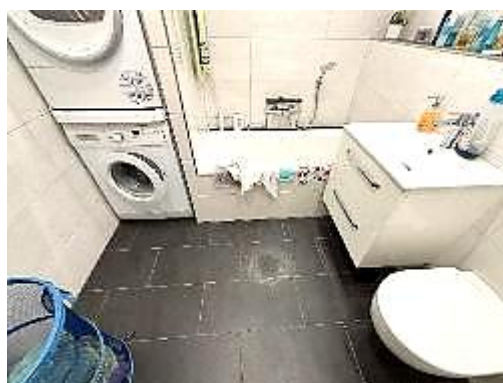
(Behobener) Wasserschaden im Bad, Boden
