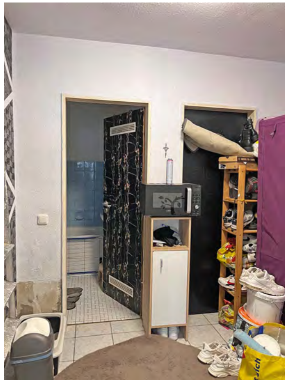
Diele in Richtung Bad und Abstellraum mit Wasserschaden
