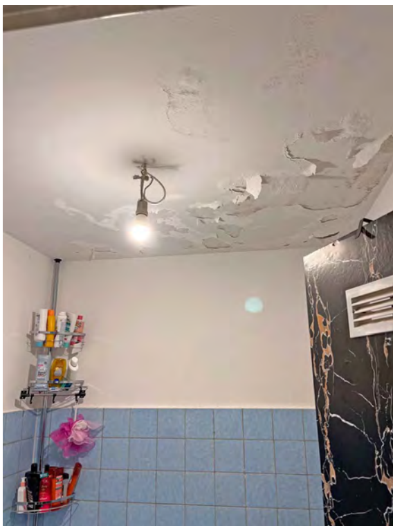
schadhafte Decke im Bad
