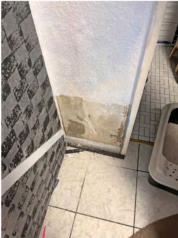
Leitungswasserschaden in der Diele
