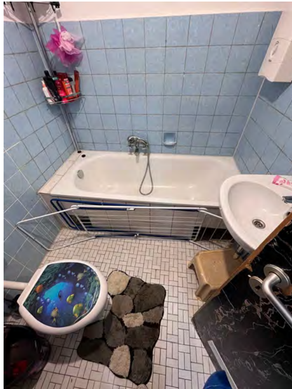
Bad mit Leitungswasserschaden (Lecksuchöffnungen unter der Badewanne)
