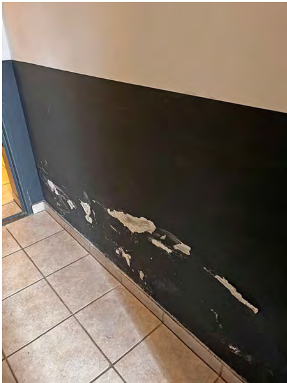
Leitungswasserschaden im Kellerflur
