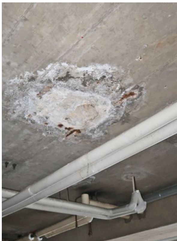
Teilansicht Decke Parkdeck, ehemaliger Wasserschaden
