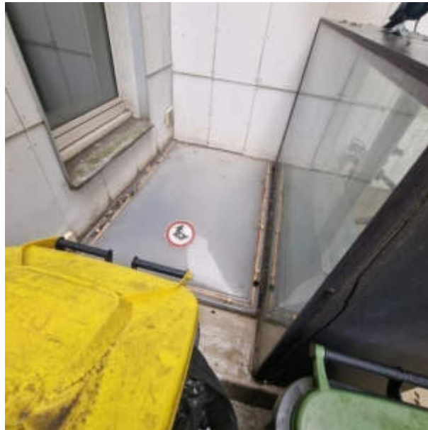
Lichtkuppel im Innenhof für den Keller
