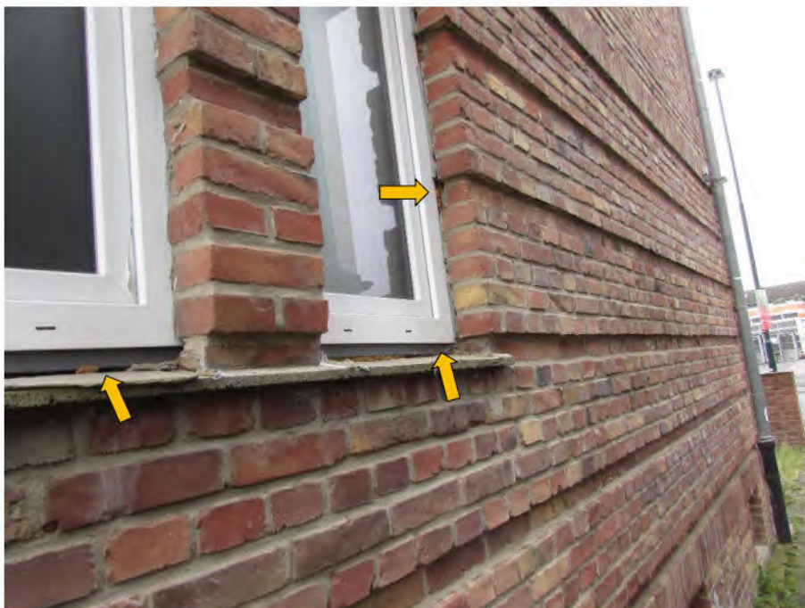
Foto 12: Wohnhaus, nicht ordnungsgemäß beigearbeitete Fenster
