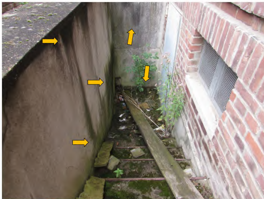
Foto 10: Wohnhaus, Kelleraußentreppe, Feuchtigkeit im Boden- und Wandbereich
