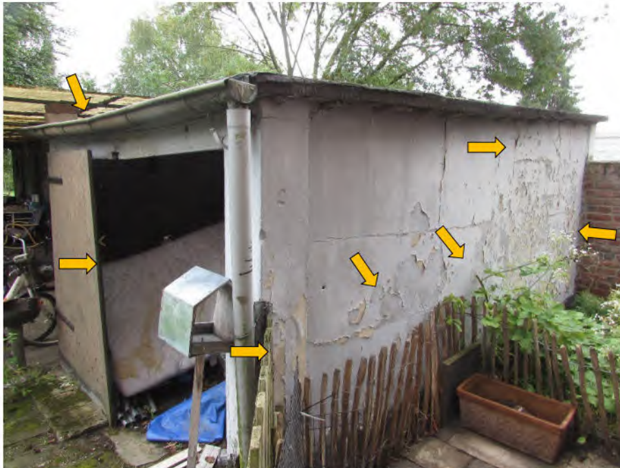
Foto 15: Nebengebäude, Garage, Schäden und Feuchtigkeit an der Fassade, verbeulte Dachrinne, beschädigtes Tor
