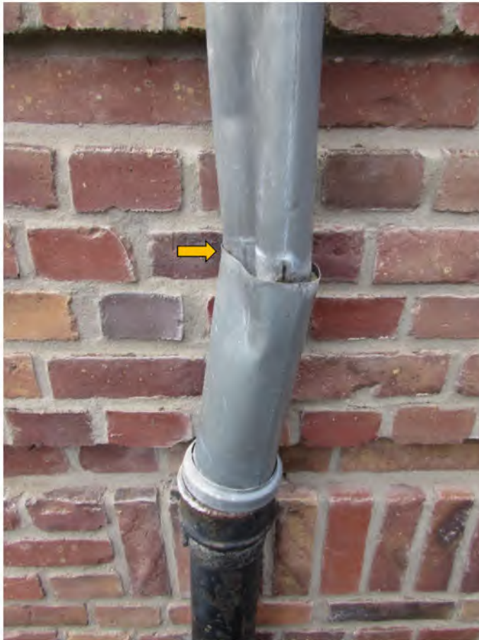
Foto 11: Wohnhaus, verbeultes Fallrohr
