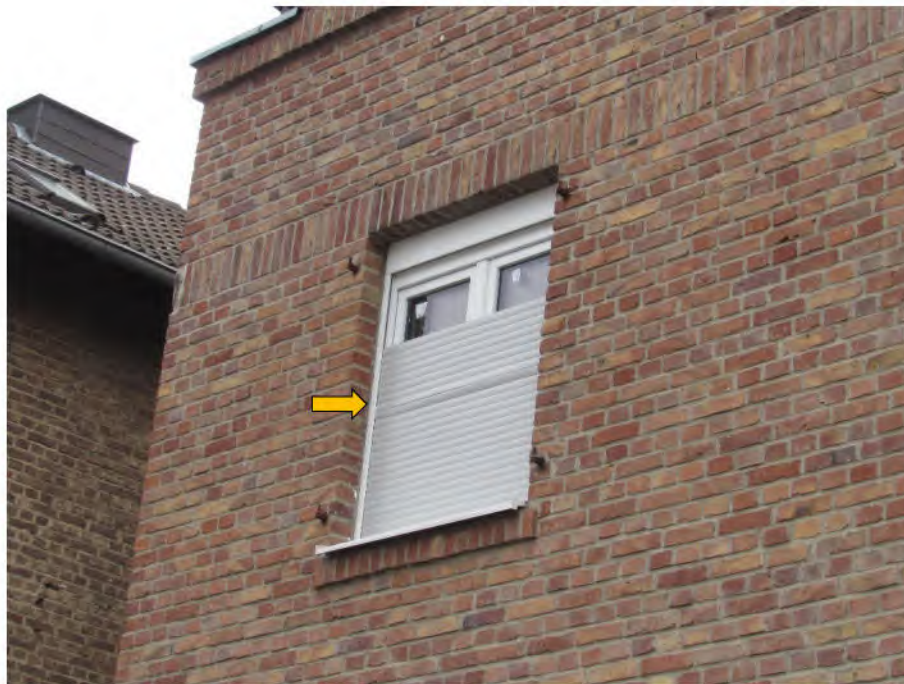
Foto 5: Wohnhaus, beschädigte Rollläden
