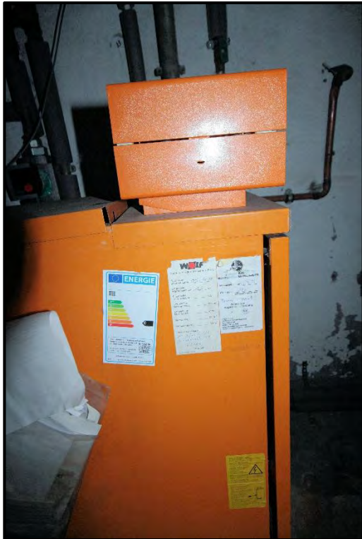
Bild 31: Gas-Heizungsanlage im Heizungskeller
