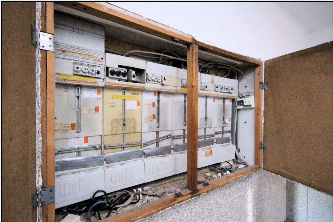
Bild 15: Zähler und Sicherungsschrank im Treppenhaus im Erdgeschoss (Zähler demontiert)
