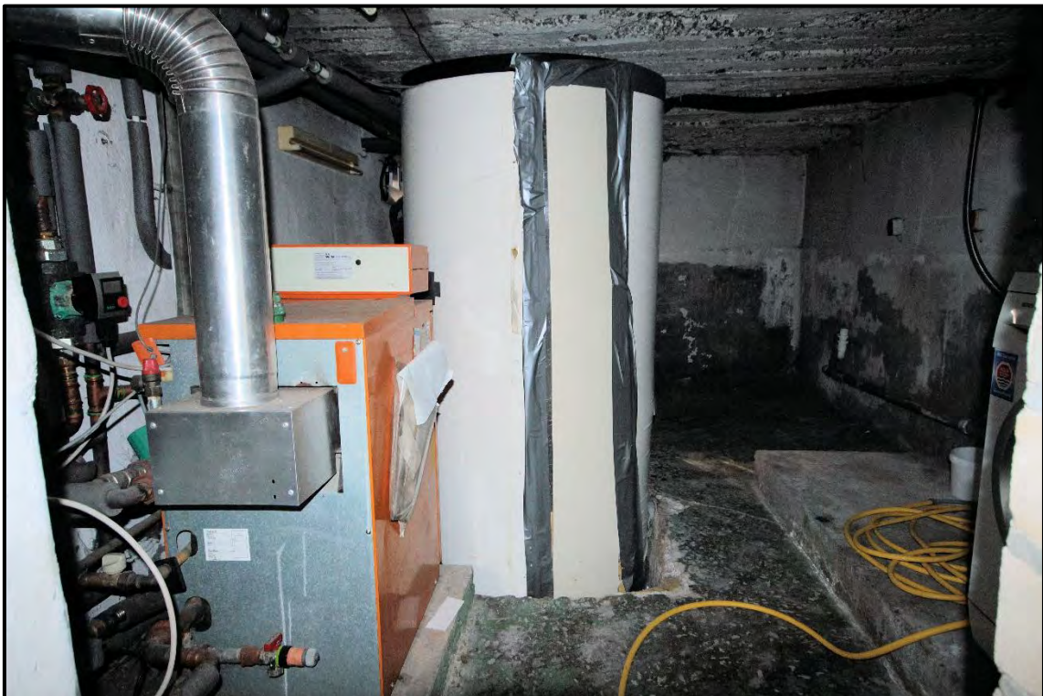
Bild 30: Heizungskeller mit Gasheizung und Warmwasserspeicher der Solaranlage
