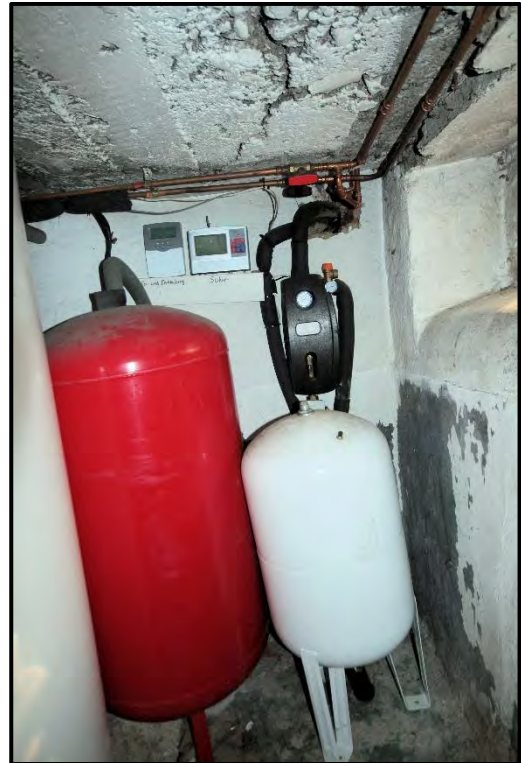
Bild 32: Ausgleichsbehälter der Solaranlage im Heizungskeller
