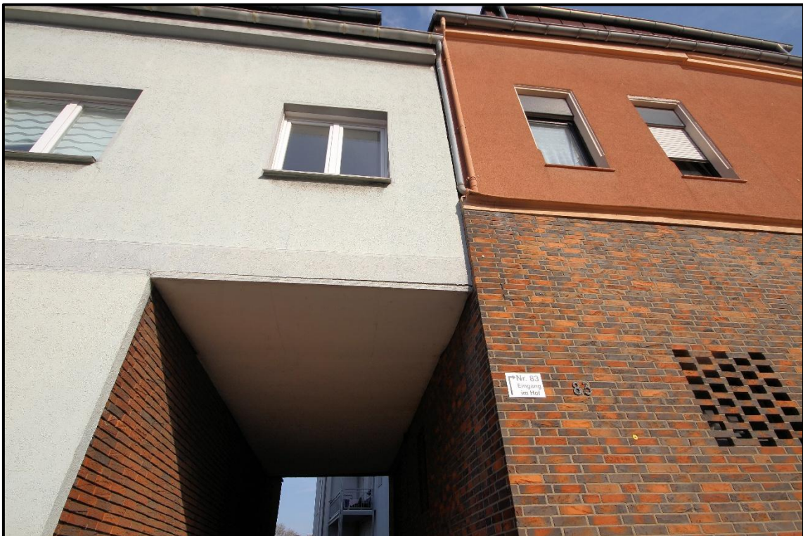
Bild 8: Schadhafte Deckendämmung der Durchfahrt
