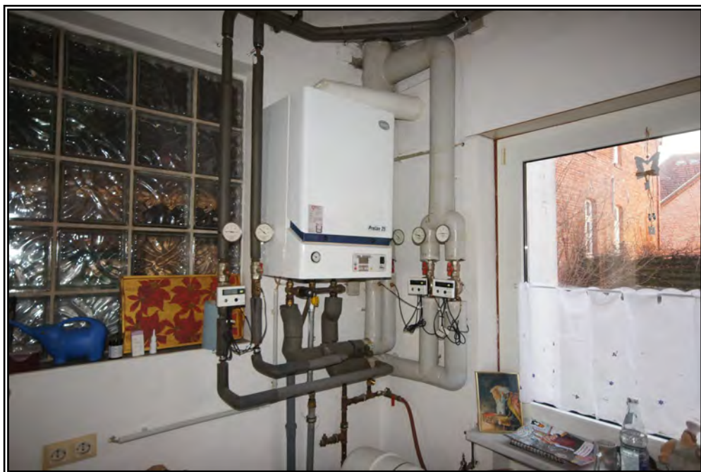
In der Küche des Erdgeschosses befindliche Heizung
