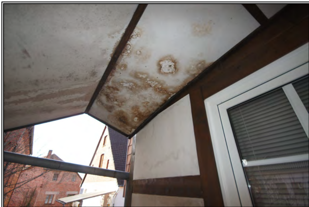
Feuchtigkeitsschaden im Bereich der Überdachung
