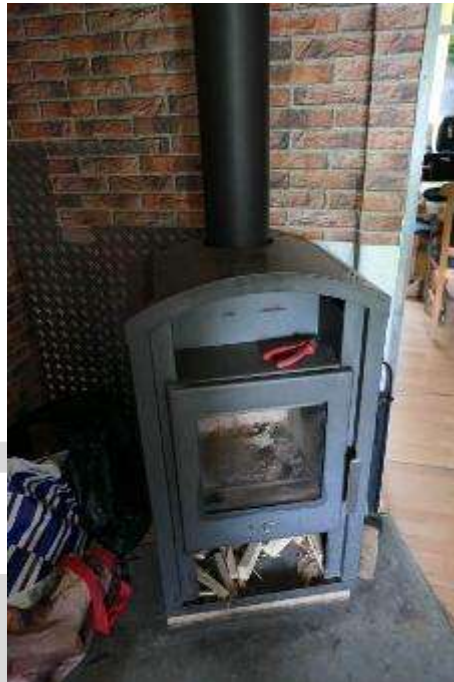
Bild 17 Holzkaminofen im Wohnraum/Küche
