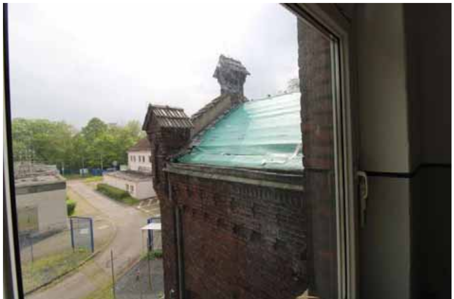
Sicht vom Flur aus auf die fehlende Dachein- deckung / OG Haus 17
