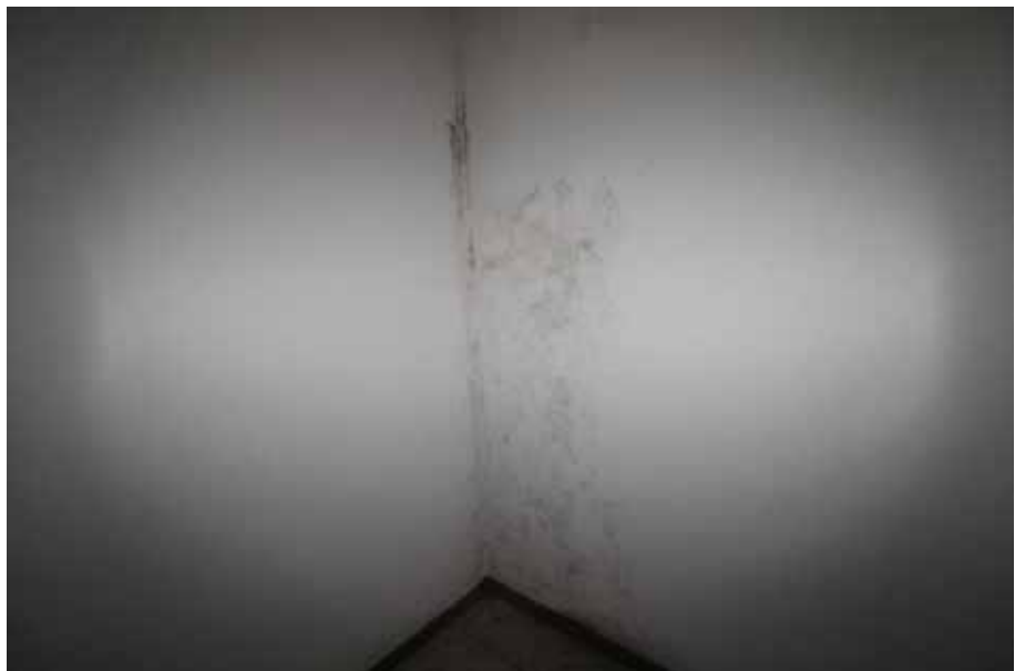
Sicht auf einen Feuch- teschaden im Wand- bereich des Treppen- raums / EG Haus 15
