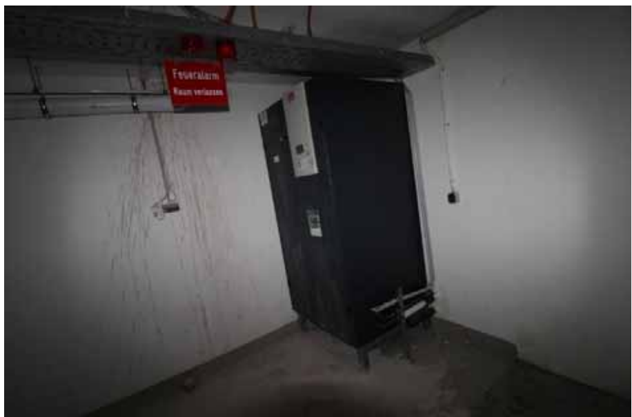
Sicht in die Heizzent- rale / KG Haus 15
