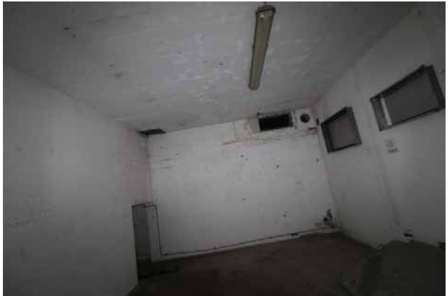
Sicht in den Technik- raum / EG Haus 14
