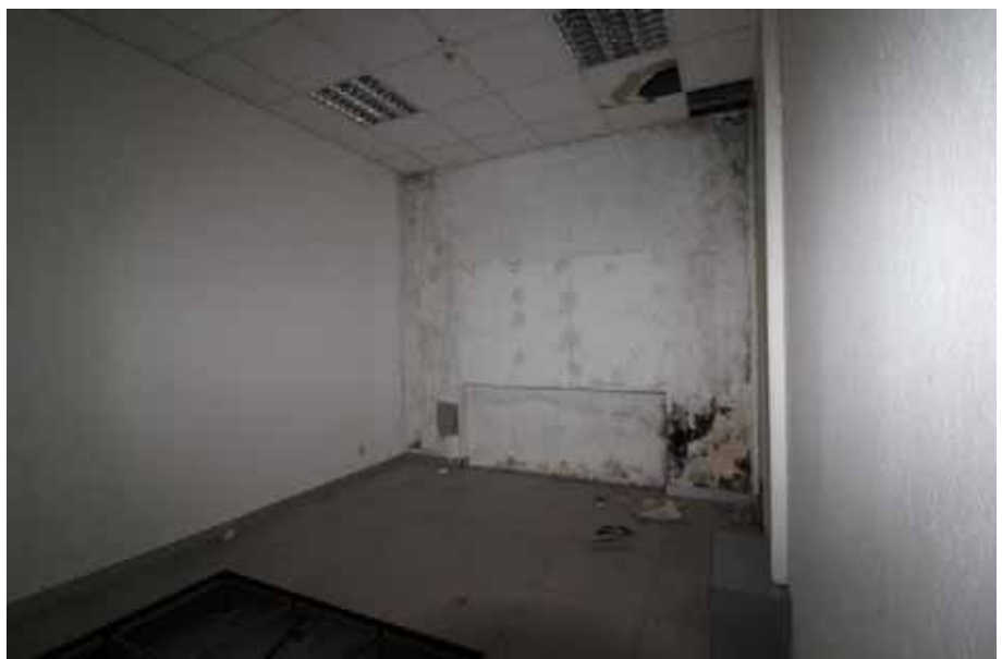
Sicht in den Klima- raum mit Feuchte- schaden im Wandbe- reich / EG Haus 15
