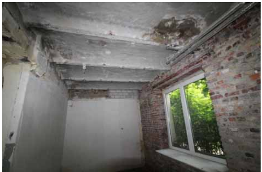
Sicht auf einen Feuch- teschaden mit Schwammbe- fall im Deckenbereich von Raum 1 / EG Haus 14
