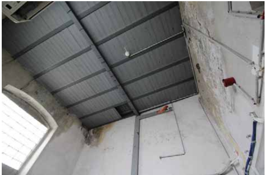
Sicht in den Betriebs- raum / EG Haus 17
