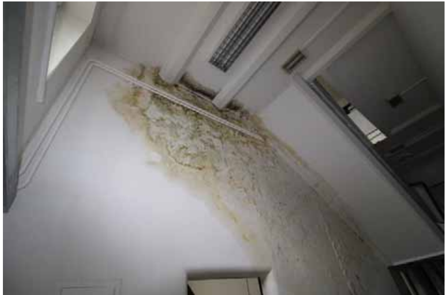
Sicht auf den Feuchteschaden mit Schimmelpilzbildung im Wandbereich vom Flur / EG Haus 17
