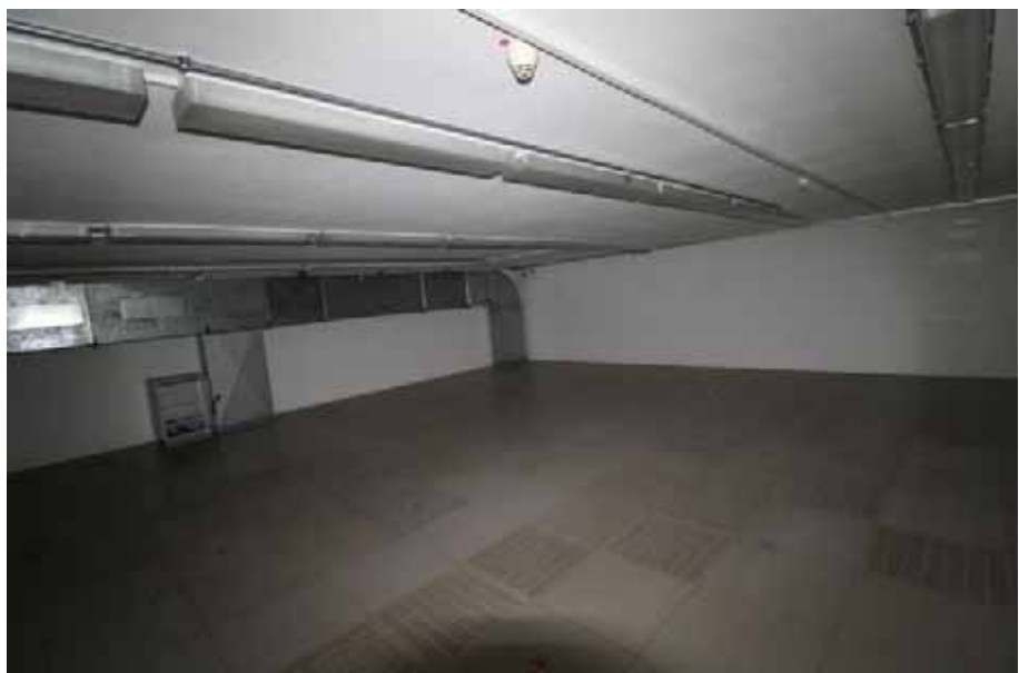
Sicht in den Raum 6 mit Doppelboden / EG Haus 14
