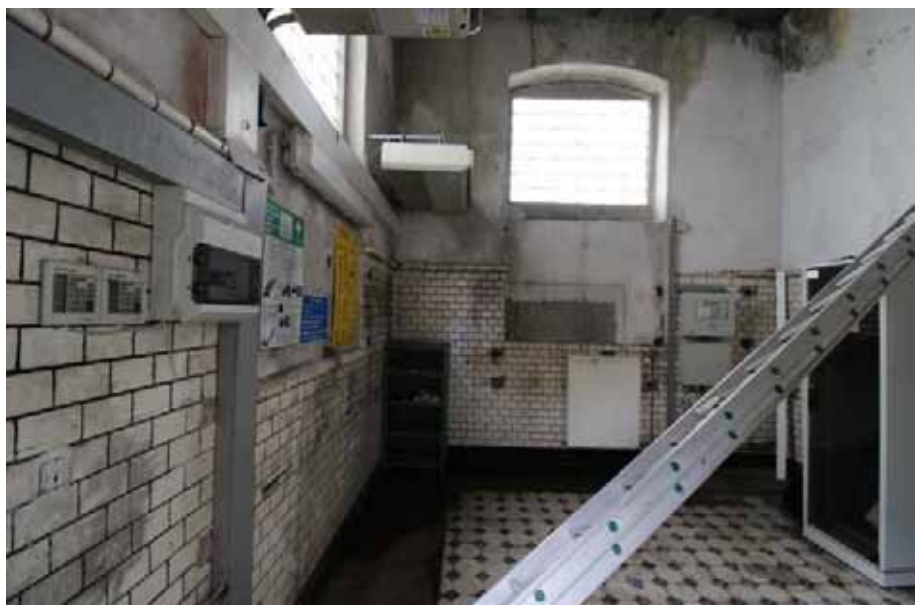
Sicht in den Betriebs- raum / EG Haus 17
