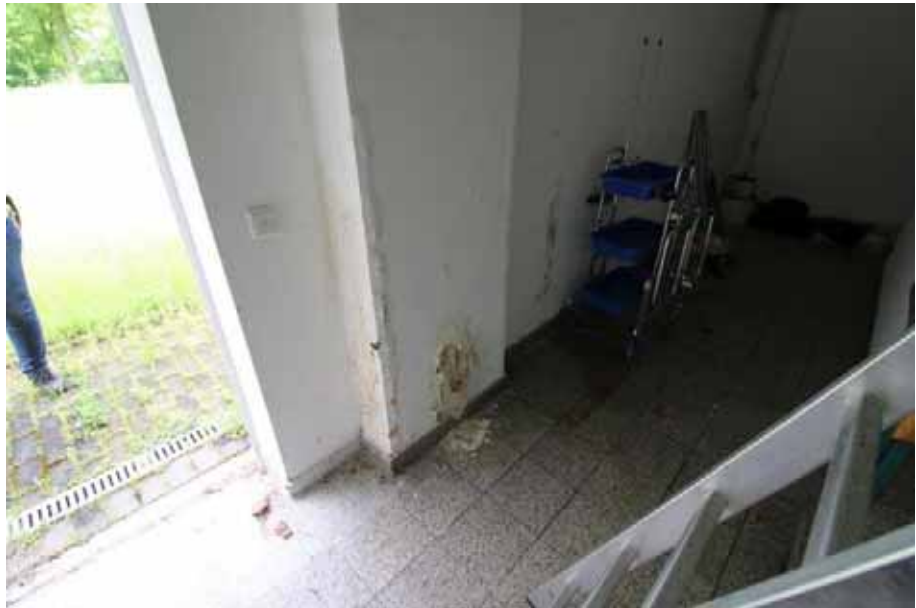
Sicht auf den Feuchteschaden im Wandbereich vom Flur / EG Haus 16
