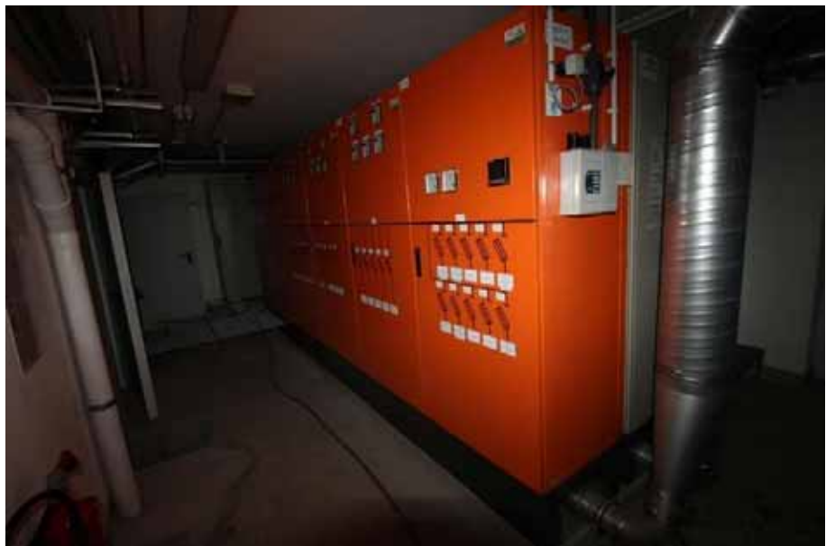
Sicht in einen Raum der Stromversorgung / KG Haus 15
