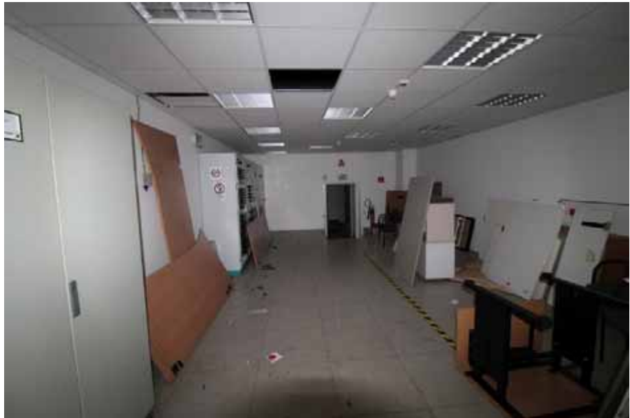
Sicht in die Haustechnik / EG Haus 15
