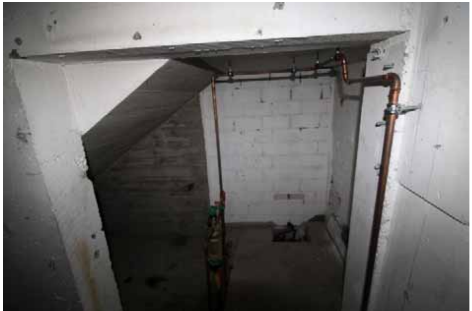
Sicht in den Technik- raum / EG Haus 14
