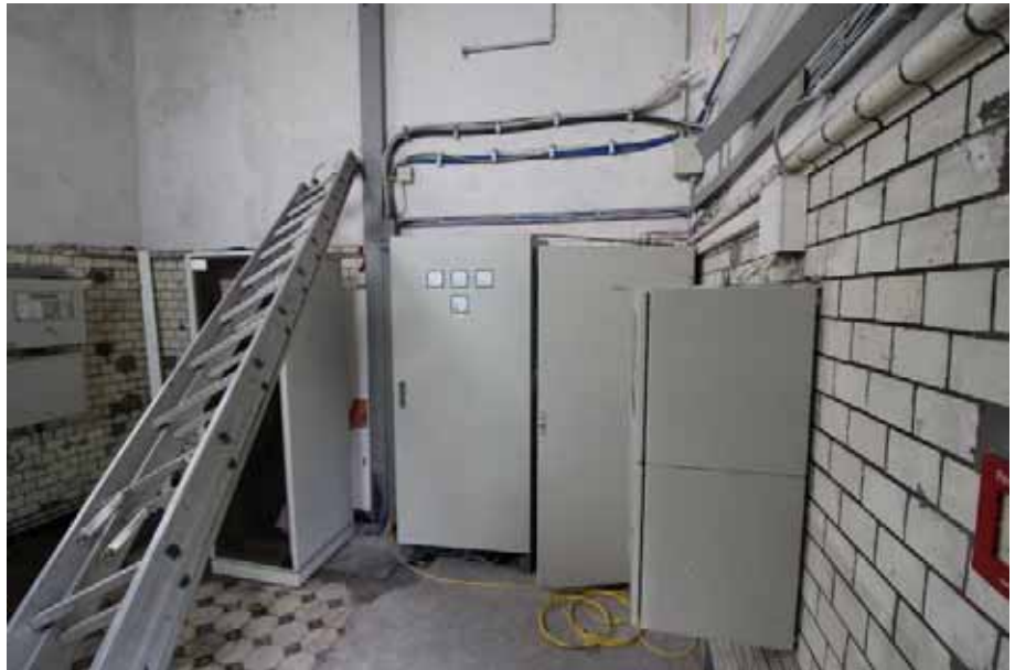
Sicht in den Betriebs- raum / EG Haus 17
