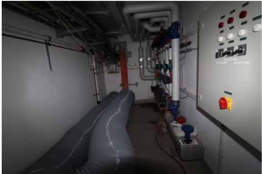
Sicht in einen Technik- raum / KG Haus 15
