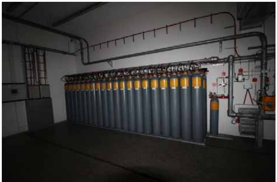
Sicht in den Löschmit- telraum / EG Haus 15
