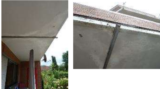
Untersicht mit tlw. starken Verfärbungen und z.T. mit Abplatzungen
