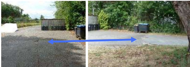
tlw. Asphalt mit Schäden (Schlaglöcher)
