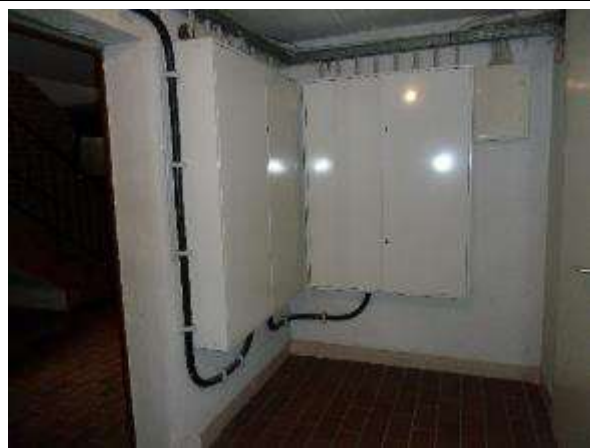
KG Flur mit Unterverteilung Elektro Hausnr. 88
