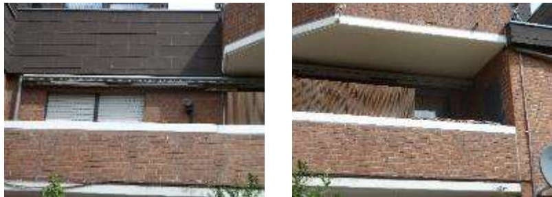
Brüstung außen tlw. Verfärbungen,
