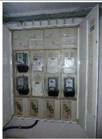
KG Unterverteilung Elektro
