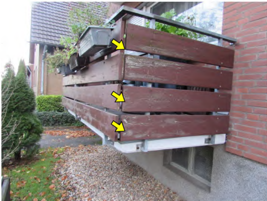
Foto 12: Balkon: tlw. verwitterte Geländerverkleidung
