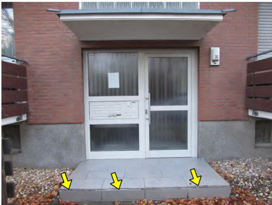
Foto 2: Hauseingang: schadhaftes Eingangspodest
