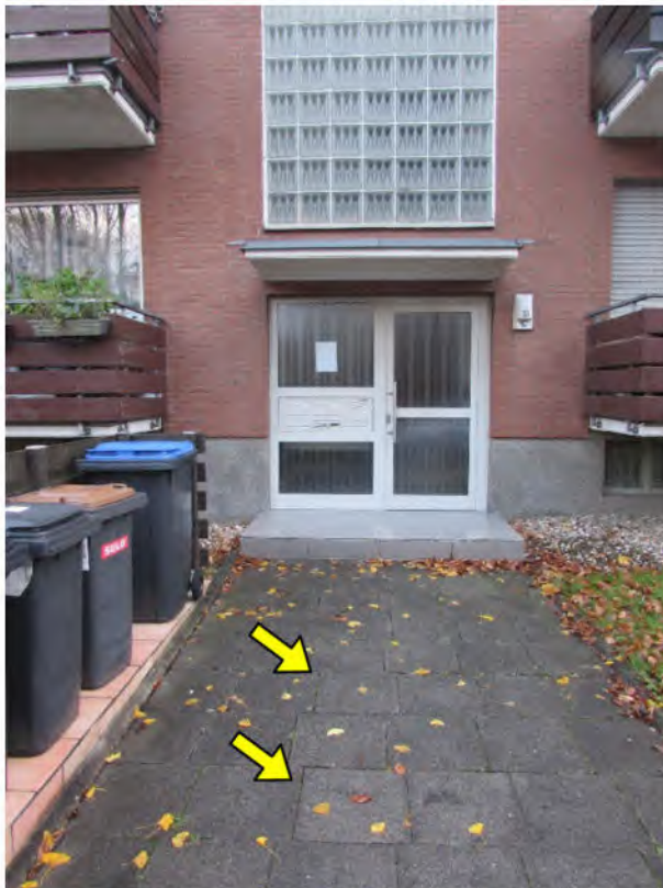
Foto 18: Zugang: tlw. abgesetzte Betonplattenbefestigung
