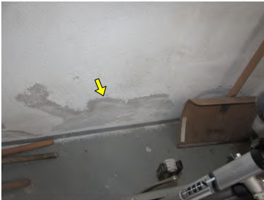
Foto 16: Kellergeschoss, Waschküche: Feuchtigkeit im Außenwandbereich
