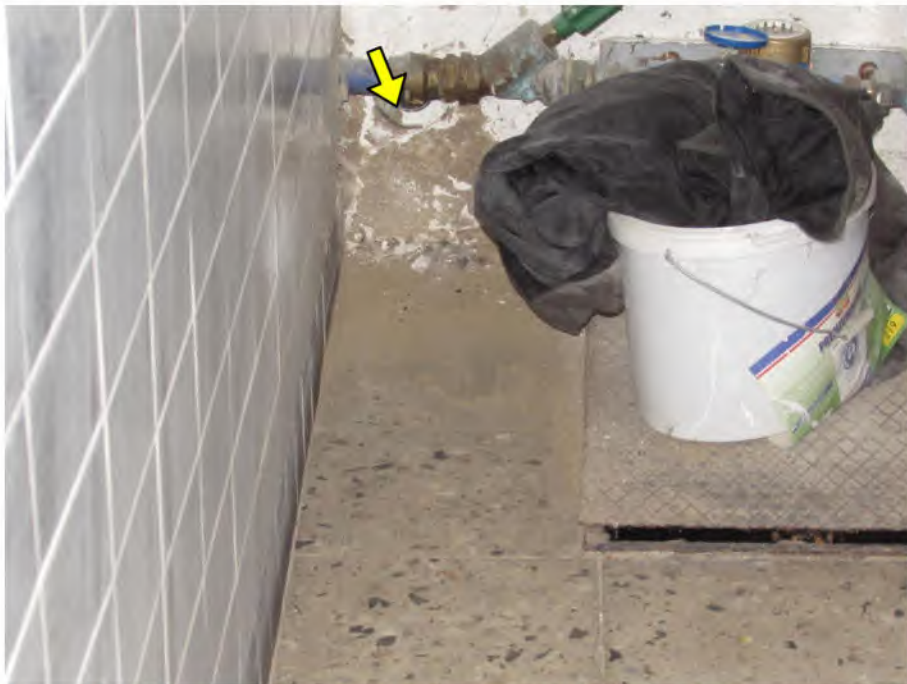
Foto 14: Kellergeschoss: Feuchtigkeit im Wandbereich
