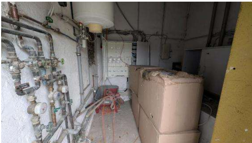
Bild D3 Beispiel Haustechnik
