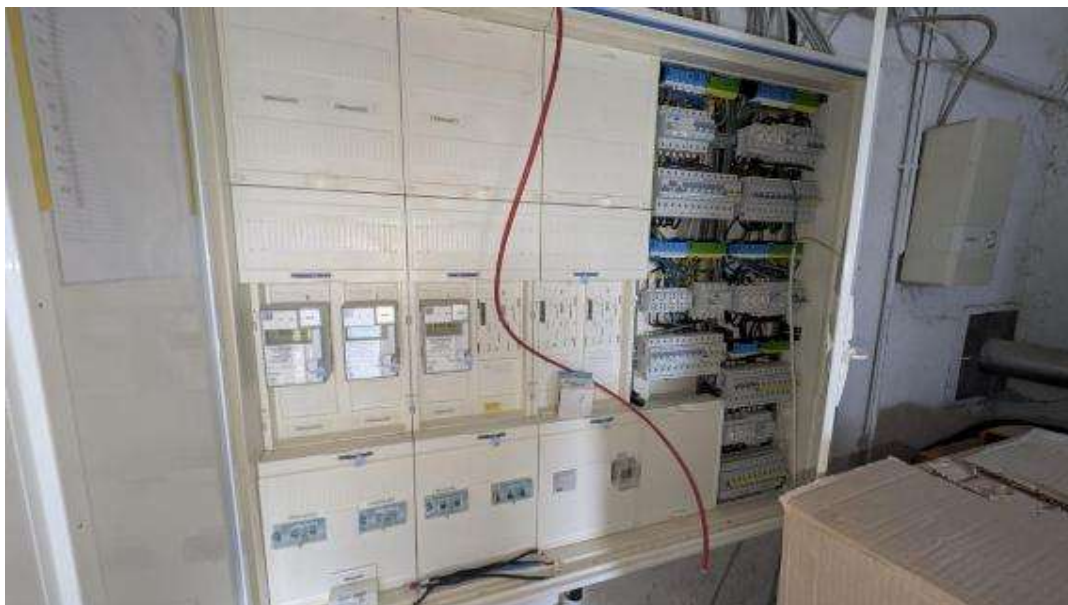
Bild D5 Beispiel Haustechnik
