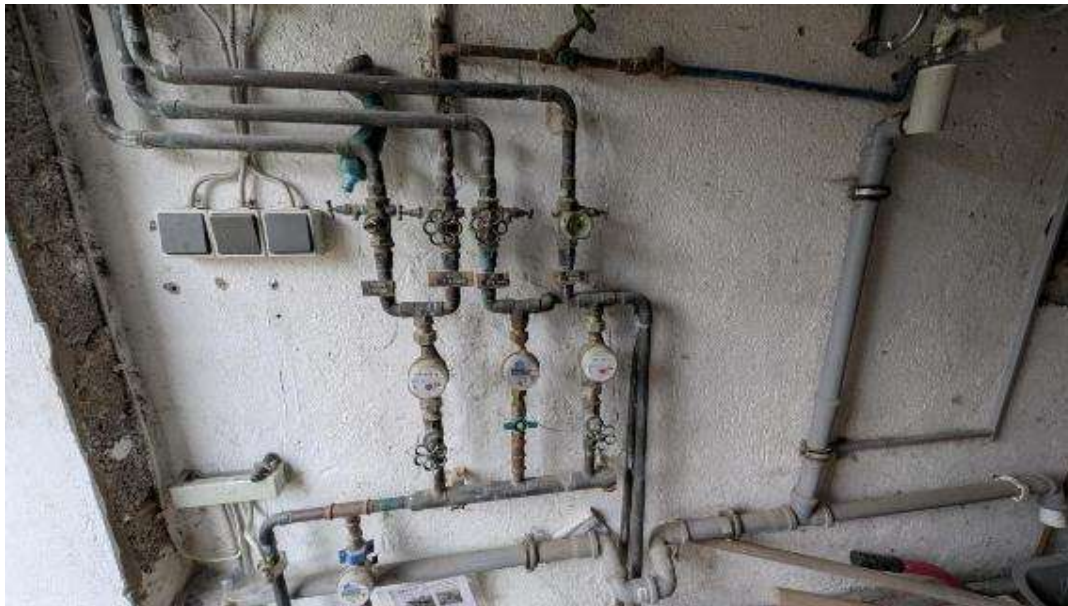
Bild D4 Beispiel Haustechnik
