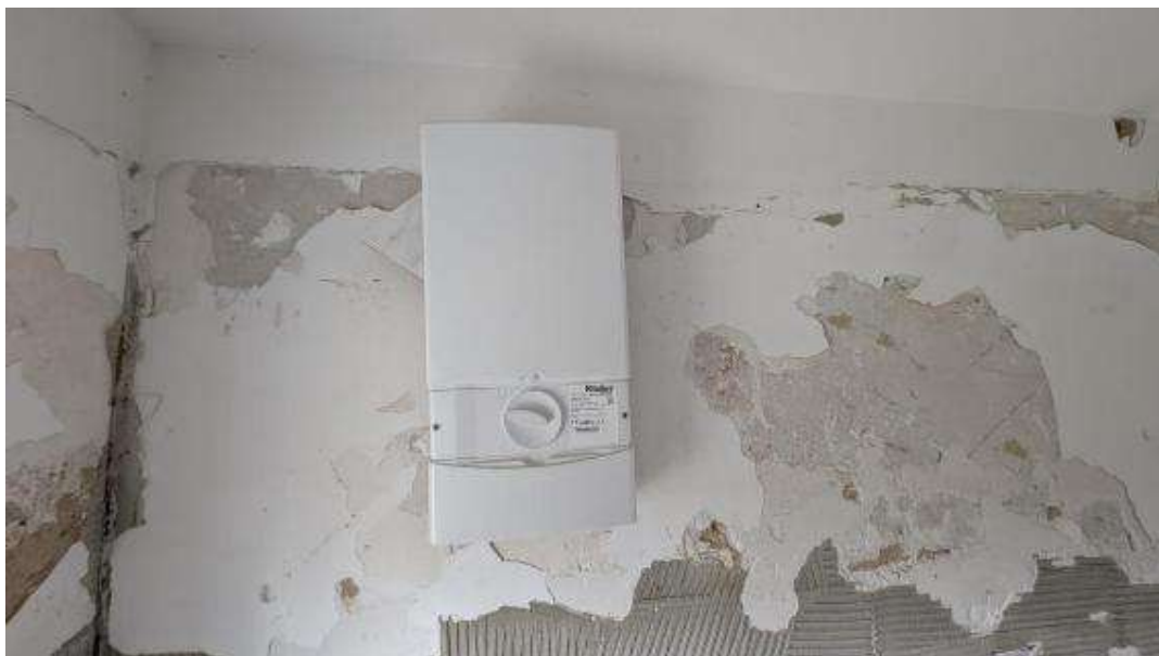
Bild D1 Beispiel Haustechnik
