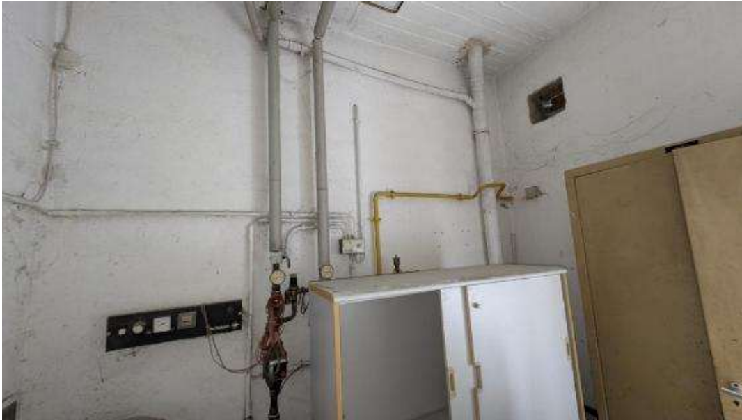
Bild D6 Beispiel Haustechnik
