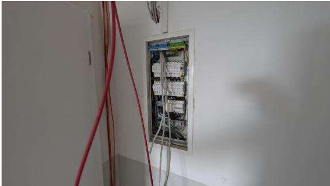
Bild D2 Beispiel Haustechnik
