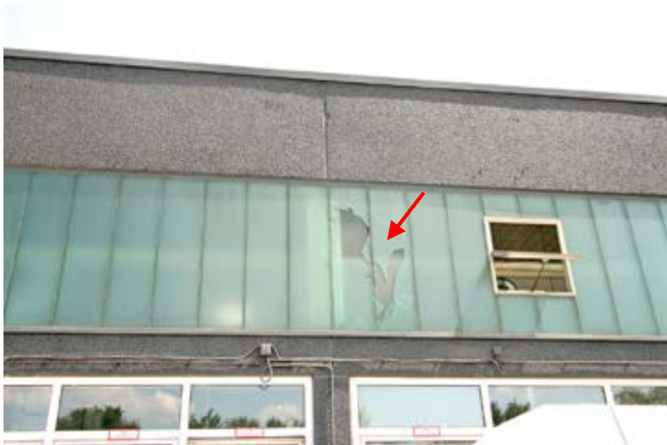
Bild 39: Schadhafte Glasscheiben im Lichtband an der Nordwestseite von Halle 3 (3. Bauabschnitt)
