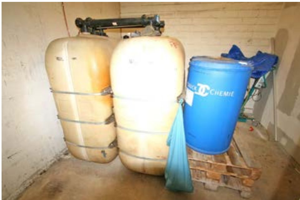
Bild 38: Fehlende Ölauffangwanne unter den Tanks im Heizöllageraum des eingeschossigen Anbaus an Halle 1 (1. Bauabschnitt)
