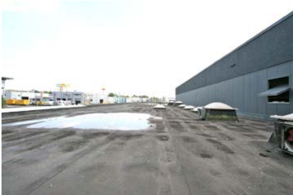
Bild 37: Rissige und erneuerungsbedürftige Dacheindeckung auf dem eingeschossigen Anbau an das Bürogebäude
