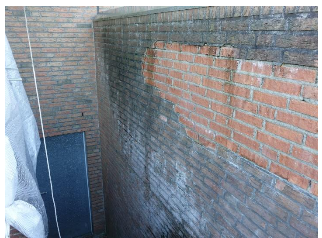
Bild 6 Detailaufnahmen Feuchteschäden Stützwand
