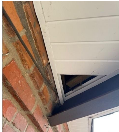
Bild 24: fehlende Verkleidung Dachüberstand
