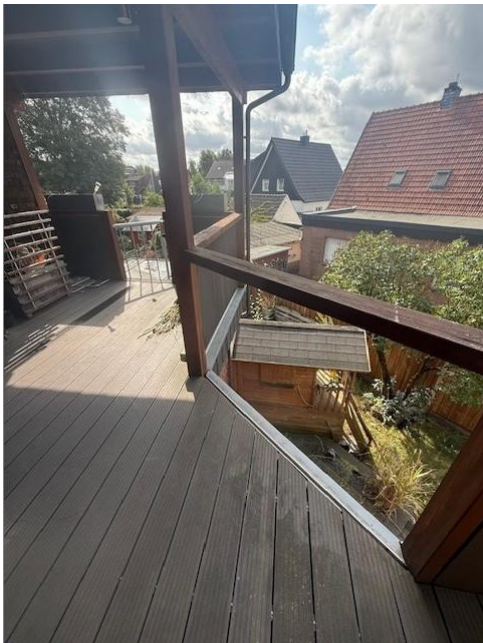
Bild 19: Balkon fehlende Brüstung
