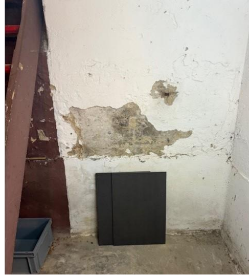
Bild 6: Putzabplatzung Aussenwand KG
