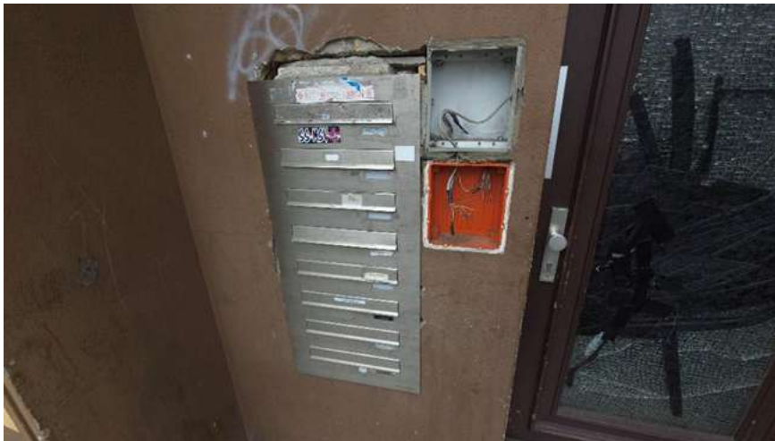
Massive Bauschäden im Hauseingangsbereich.
