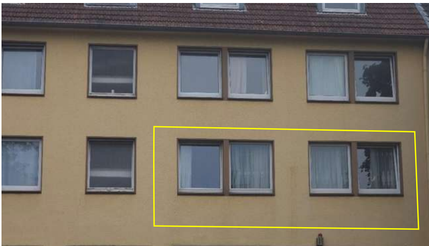
Straßenseitiger Blick auf die Fenster der WE 4. Erkennbar sind die starken Witterungsschäden an den Treppenhausfenstern mit Holzrahmen und Einfachverglasung, mitte links im Foto.
