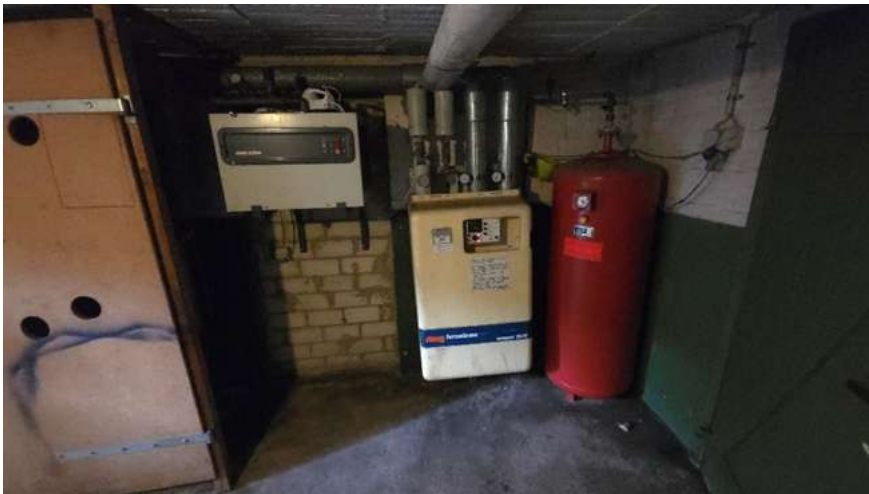
KG; Fernwärmeübergabestation im Wasch- / Trockenkellerraum.
