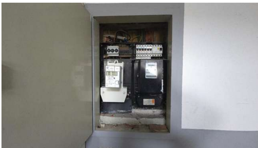
Sicherungsautomaten der Wohnungsunterverteilung und Zählertafel zu WE 4 (rechts).
