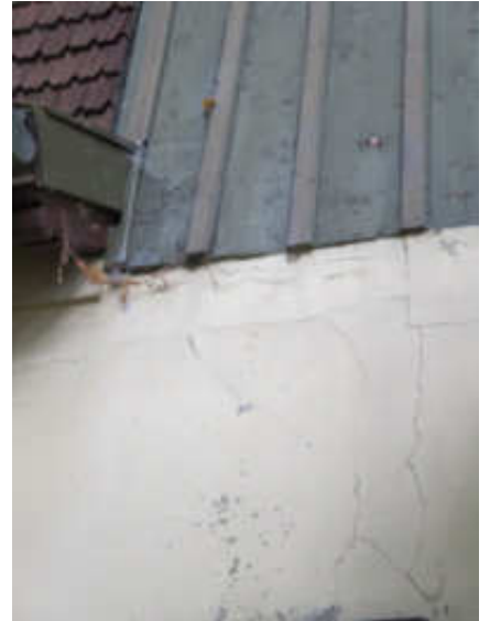
Schäden an der Fassade
