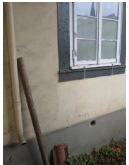
Schäden an der Fassade
