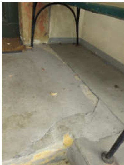
Schäden am Eingangspodest
