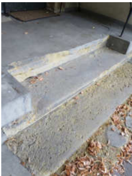
Schäden am Treppenaufgang
