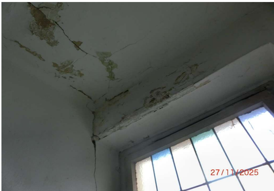
Rissbildungen und Anzeichen von Feuchtigkeit im Treppenhaus
