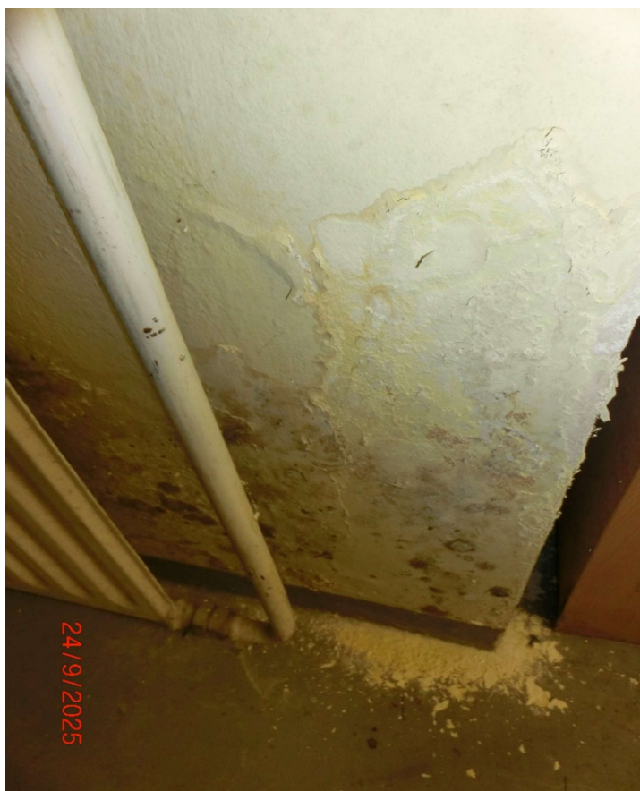
Feuchtigkeit im EG und KG
