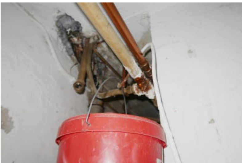
Leckage an wasserführender Leitung (Kleinmängel).
